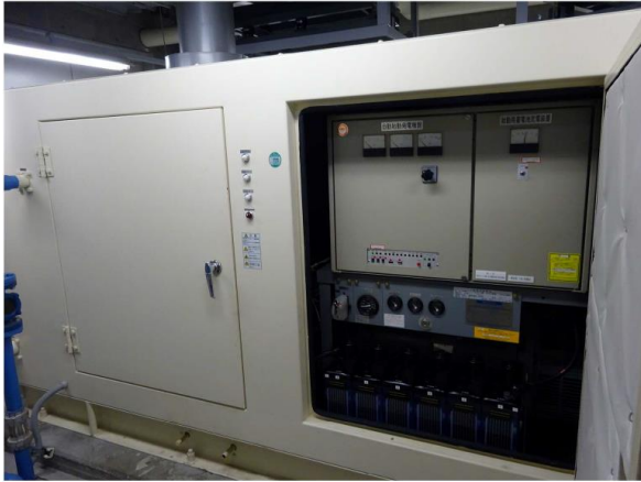
非常用自家発電設備蓄電池画像
