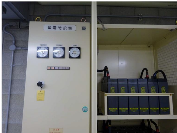
直流電源装置蓄電池画像
