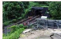
<太陽光パネルの崩落>
