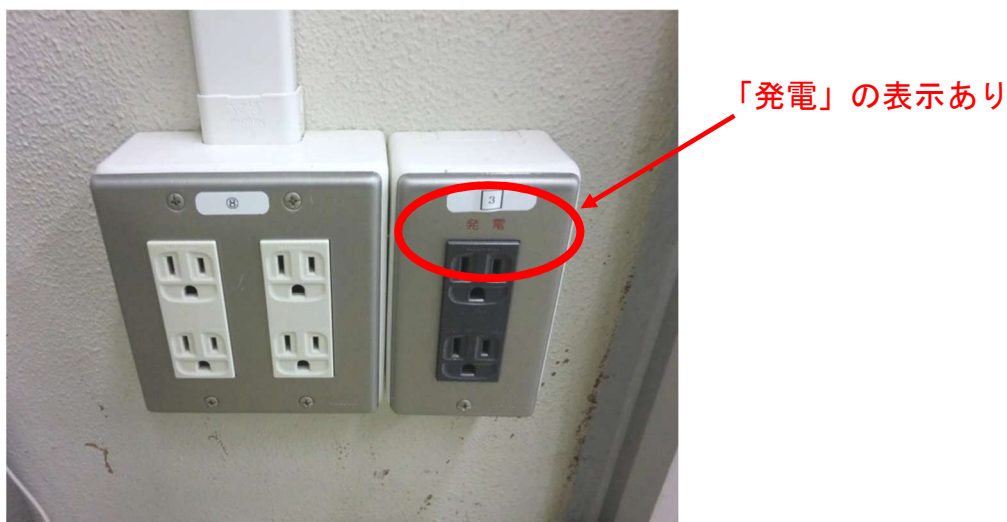
図 2.9 第二庁舎非常用電源コンセントの例（右側が非常用電源）
