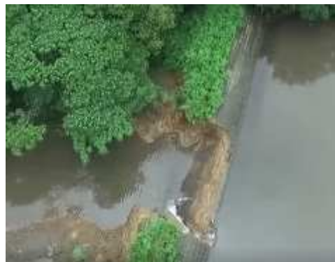
ため池決壊被害(北栄町)
