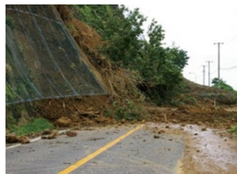
中越沖地震(平成19年)
