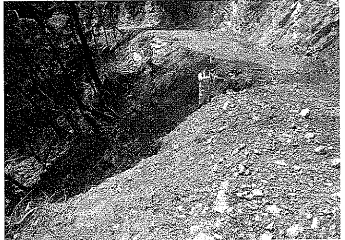
○路肩崩壊(若桜町)
