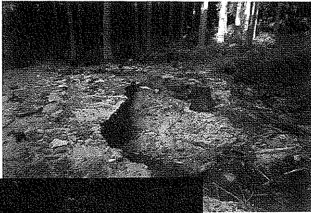
○路面洗掘(倉吉市)
