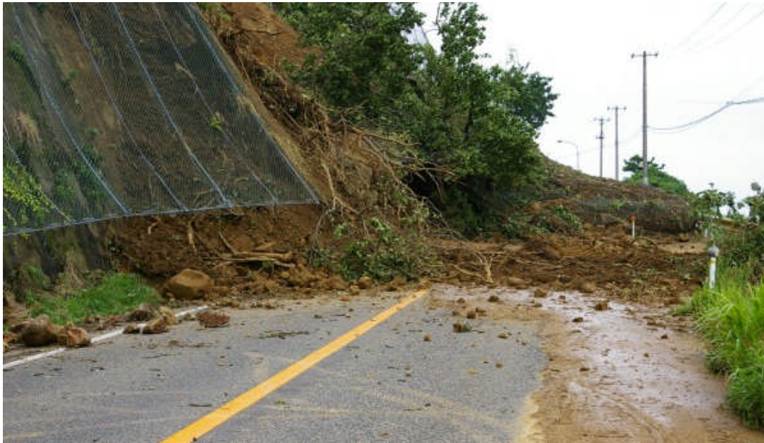
【被害写真：中越沖地震】
