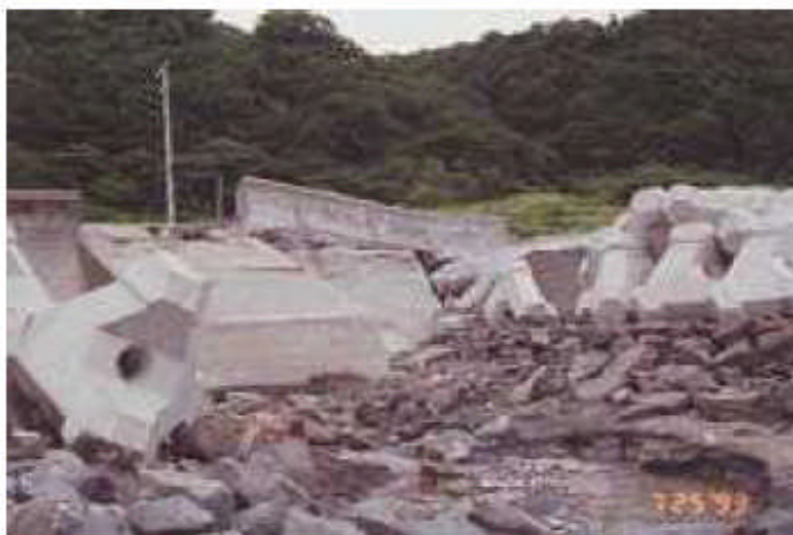
流された防波堤（大成町）
