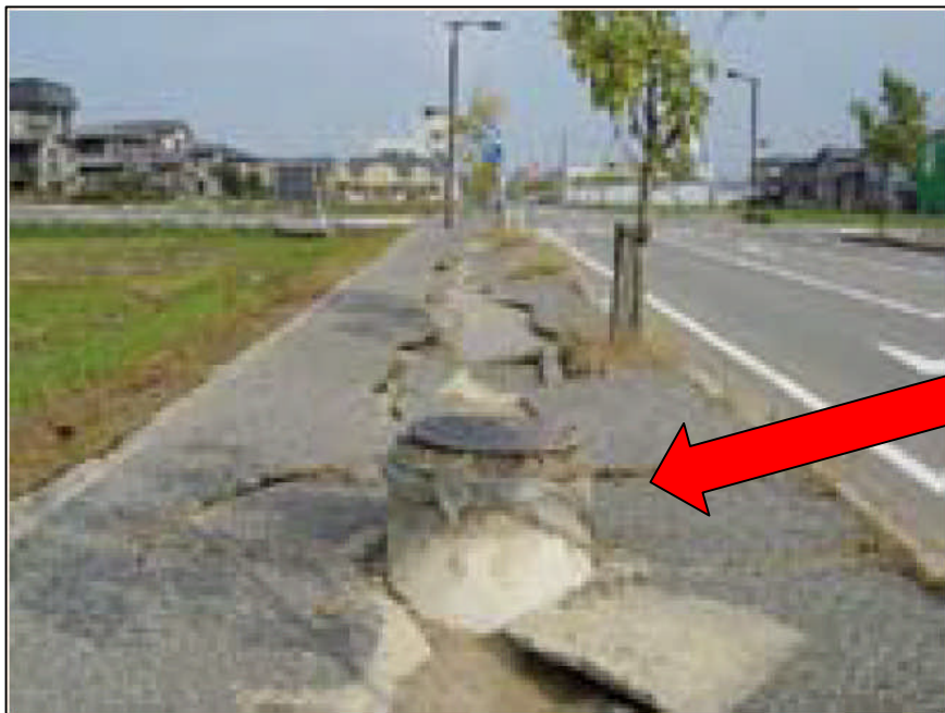
【被害写真：中越地震(平成16年)】
