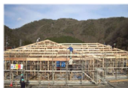
非住宅建築物
