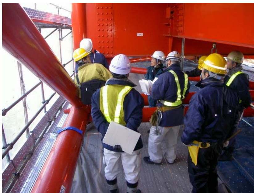
専門家による緊急現地調査事例（国道30号伊達橋の亀裂調査）
