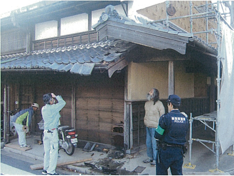
毀損直後の状態 (右側の仮設足場は現在補助事業で実施中の修理事業のもの) [写真②]
