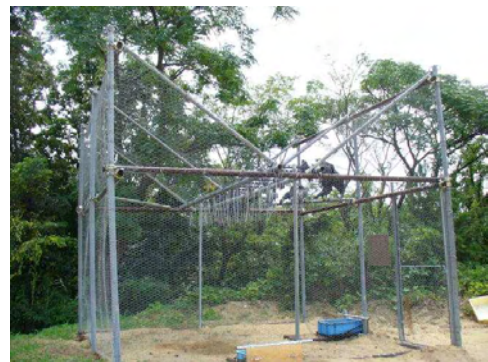
▲直管パイプを利用した捕獲檻の設置 (建設費13万円、農地から離れた場所に設置)
