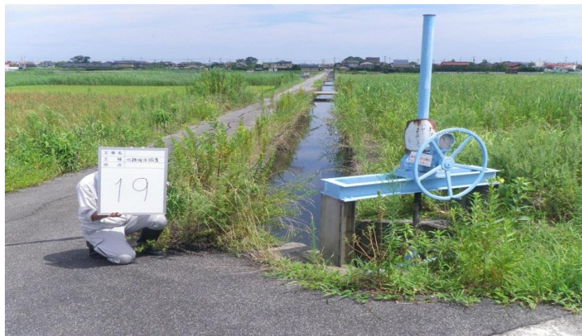
④No.29 管渠出口の土砂堆積状況
