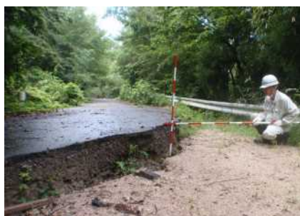
被災状況(町道の段差)
