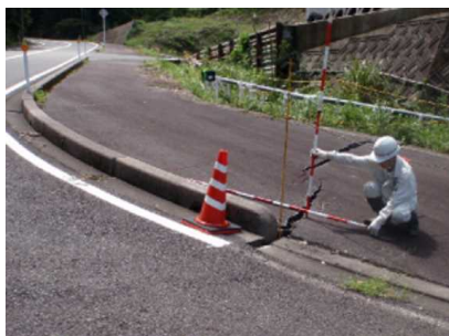
被災状況(県道の亀裂)
