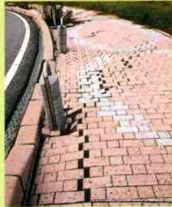
インターロッキングの変状
