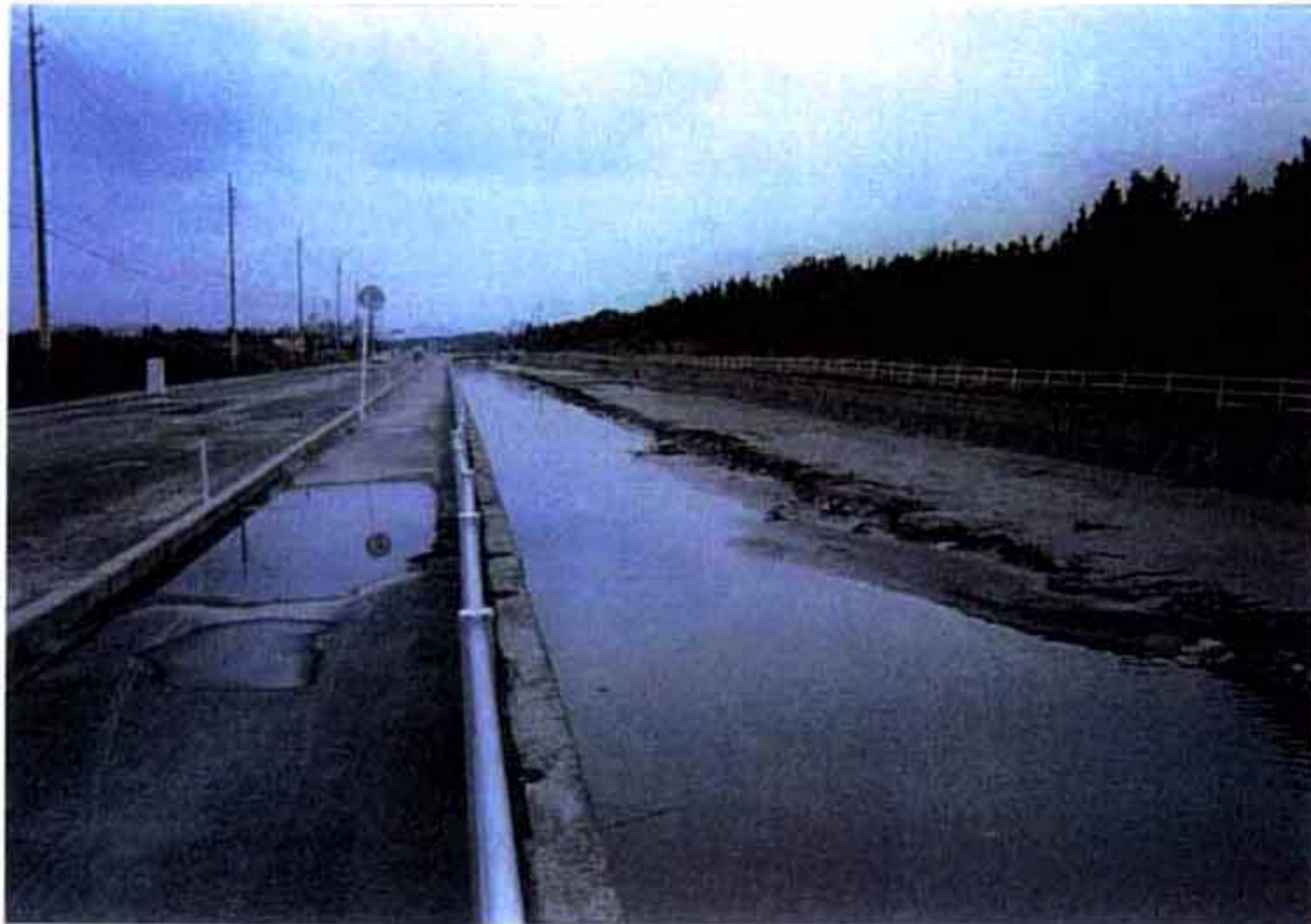
写真-7.3.1 承水路の被災状況
