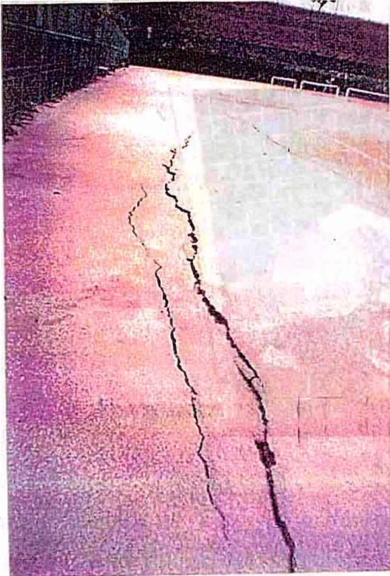
テニスコートの亀裂
