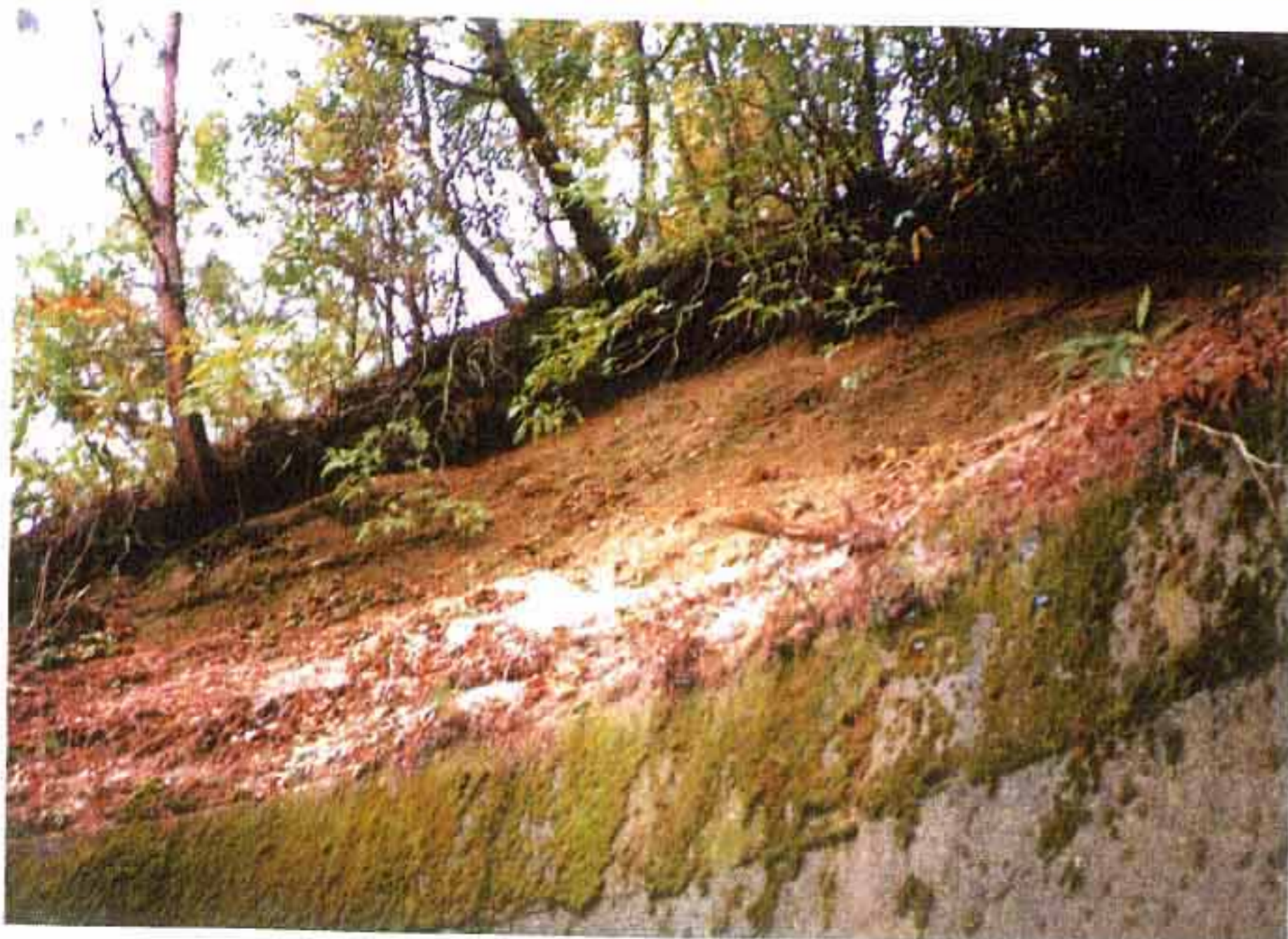
P-36 サージタンク山側斜面切取部に露出 する DL~DM 級花崗岩。一部が崩 壊し、サージタンク横に堆積した いる。
