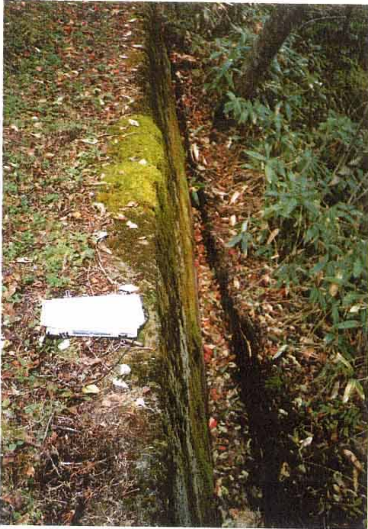
P-31 サージタンクの設置されている 388 m盤、土留擁壁と地山との間に生じ た最大幅 25cm の隙間。
