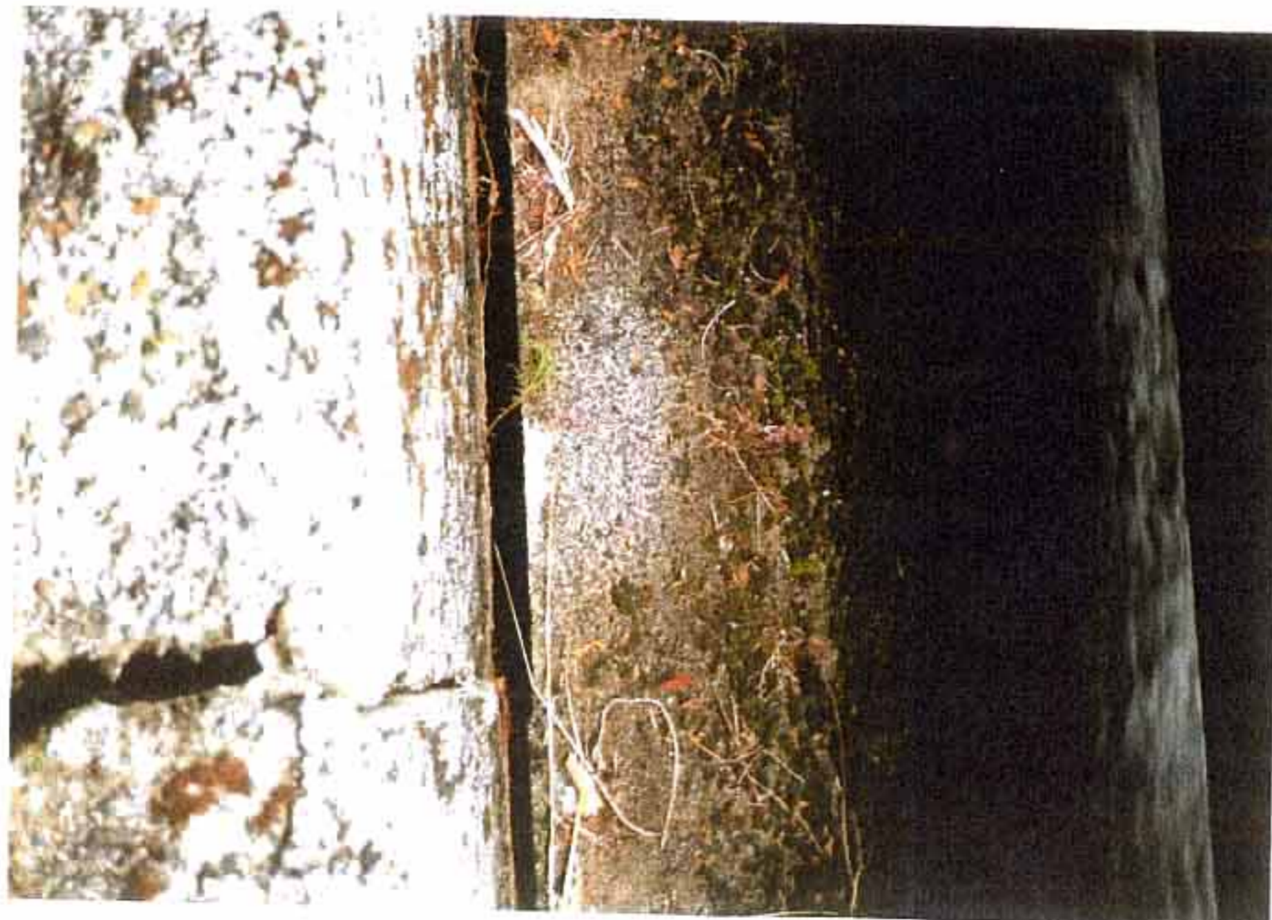
P-18 擁壁同士にも最大幅 5cm 程度の隙間が生じている。
