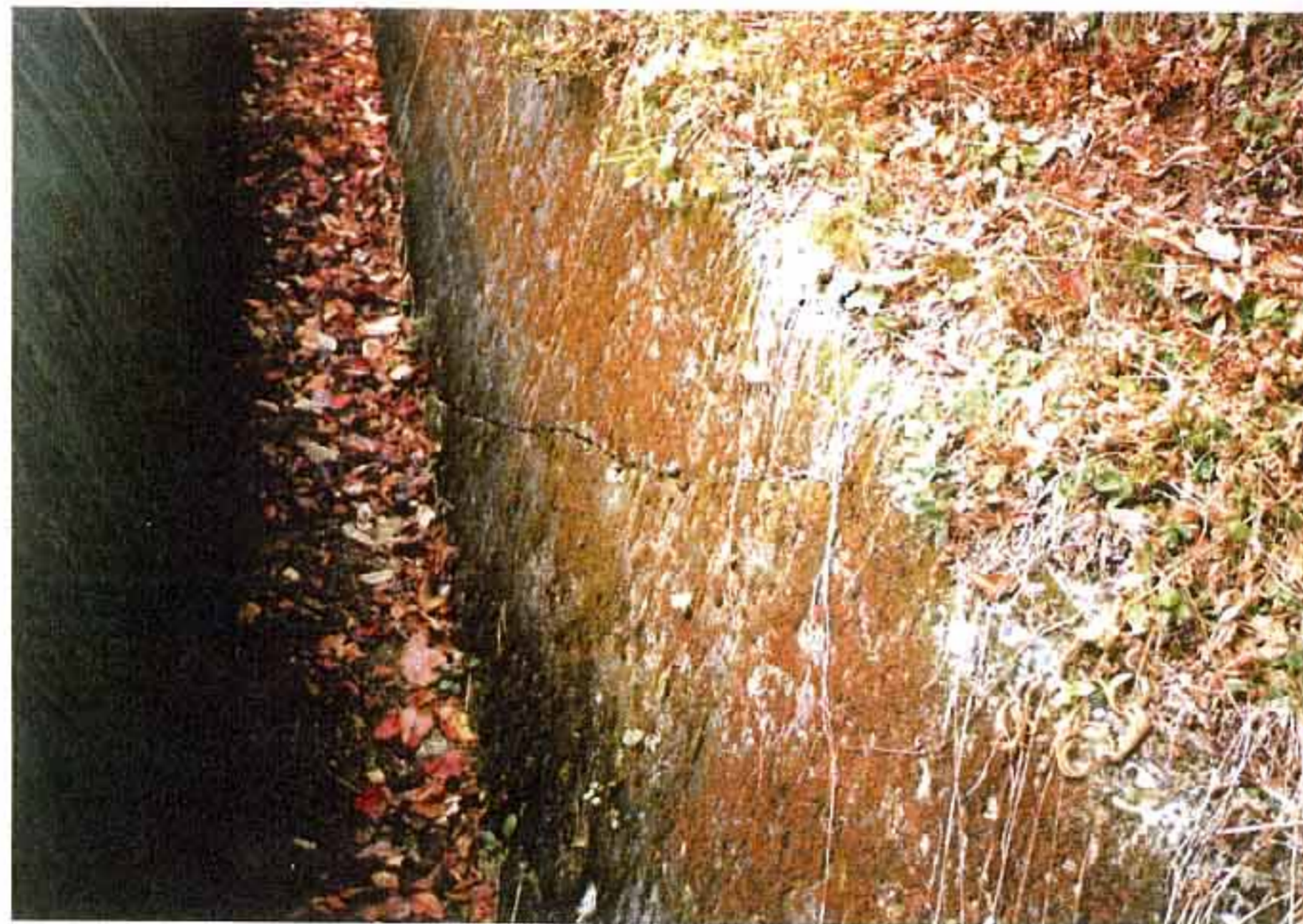
P-11 長さ約 1.5m、幅 0.5cm 程度のクラック。
