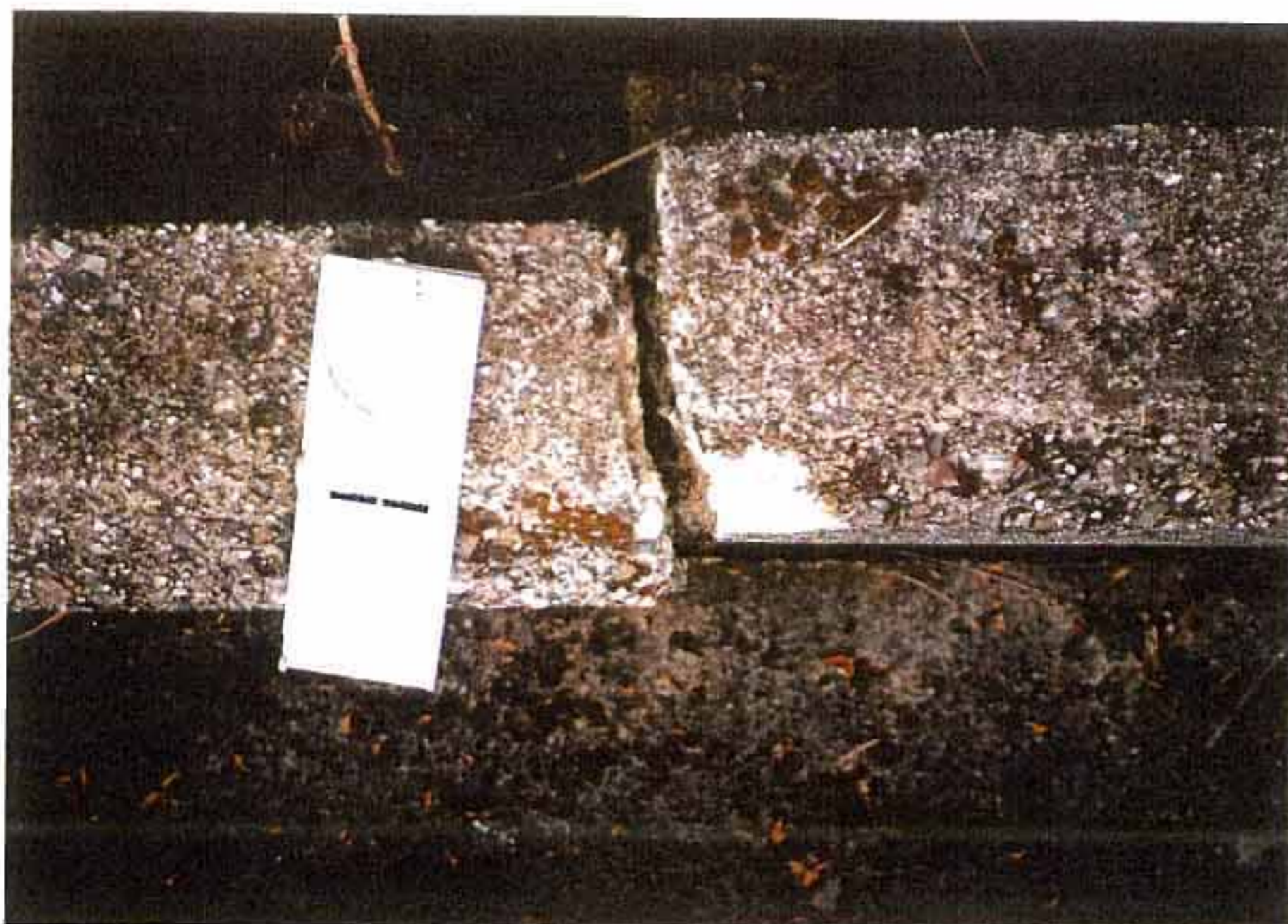
P-22 開口幅 2cm、水平方向のずれ幅 2cm のクラック。
