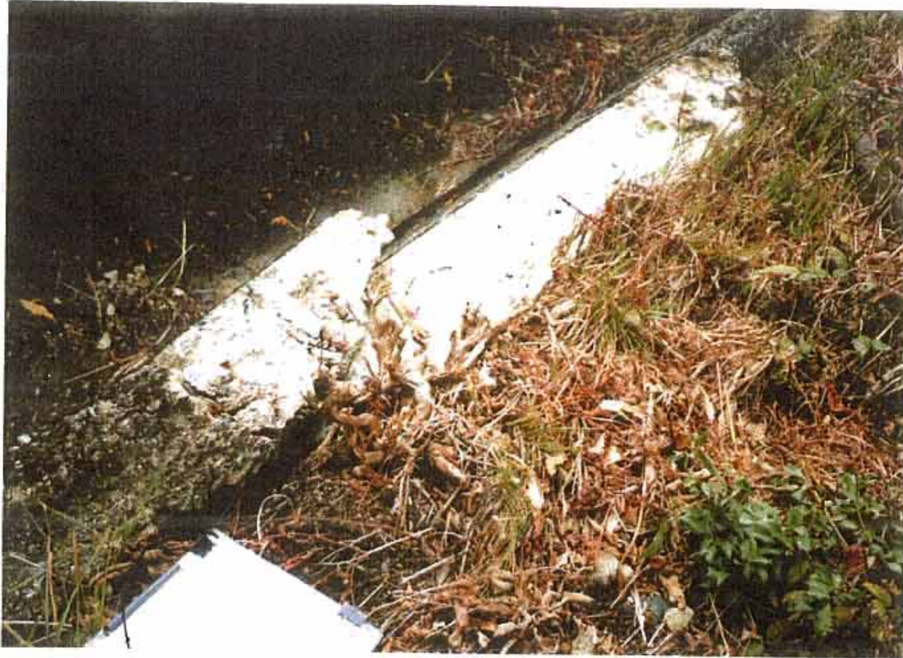
P-13 長さ約 1mにわたり、厚さ 20cm 程 度のコンクリートが破損。
