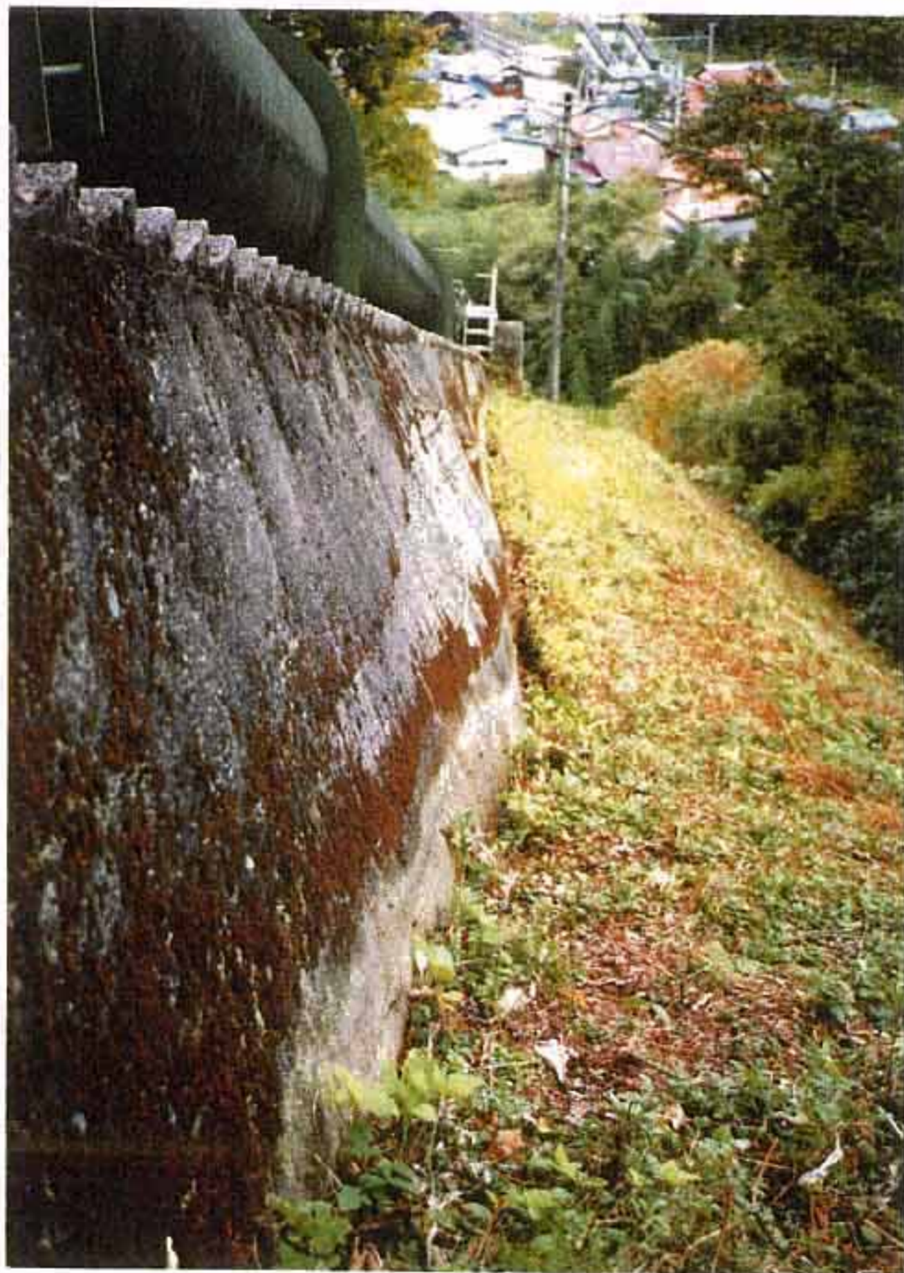
P-45 擁壁と地山（表土）との間に最大幅 15cm 程度の隙間が生じている。
