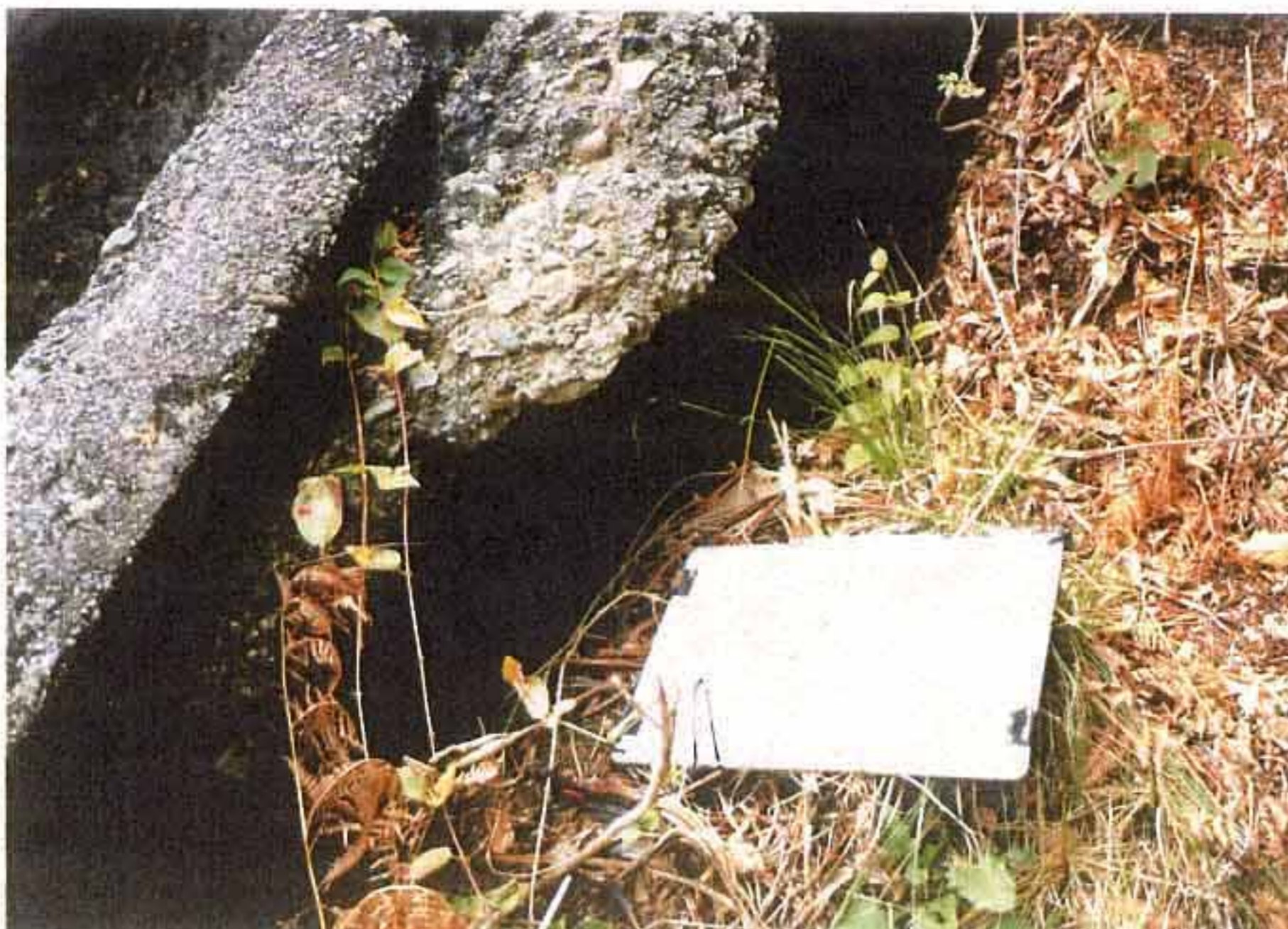
P-21 No.1 固定台直下の擁壁と地山（表土）との間に出来た隙間。
