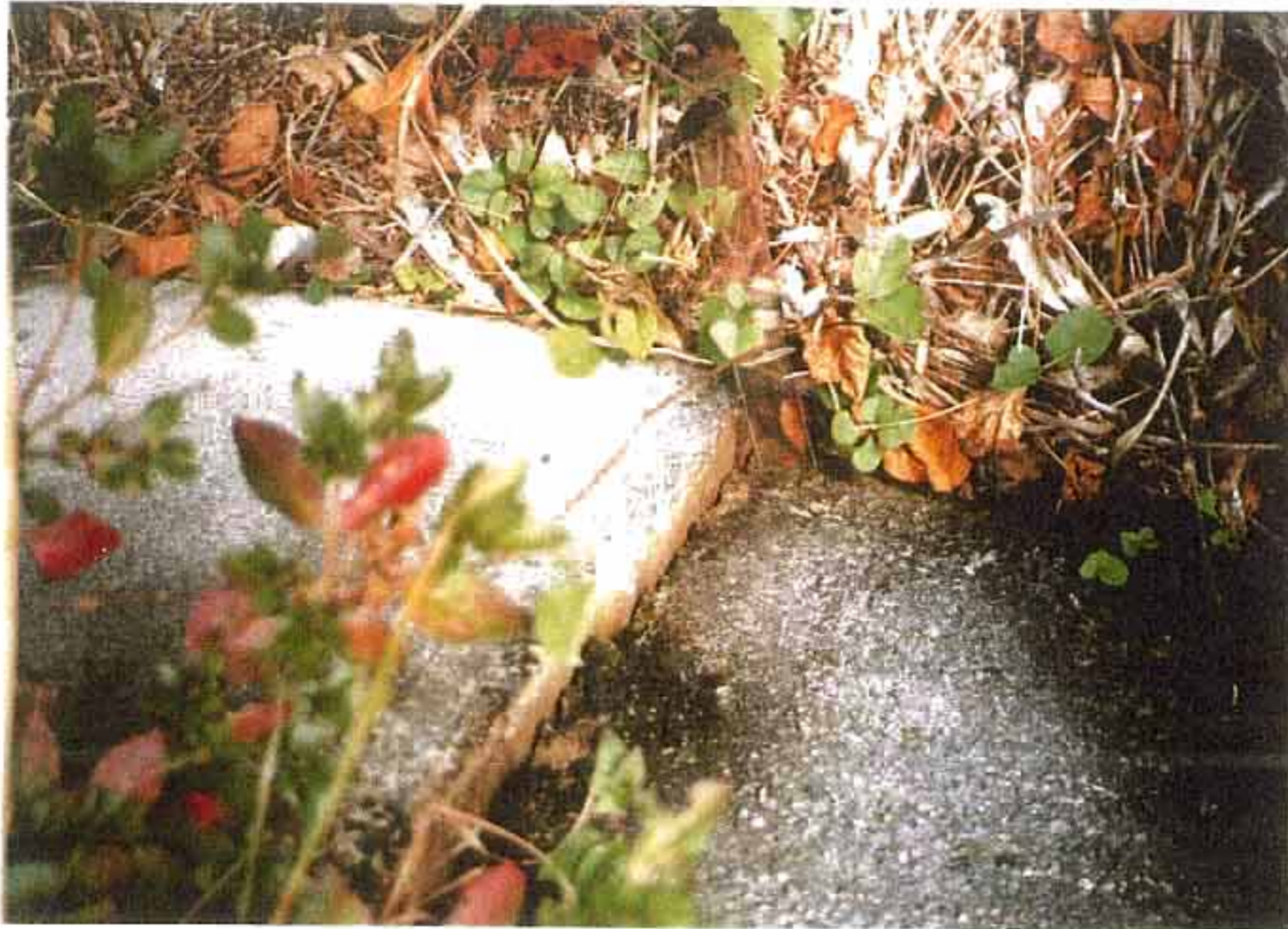
P-7 擁壁目地に4cmの段差。
