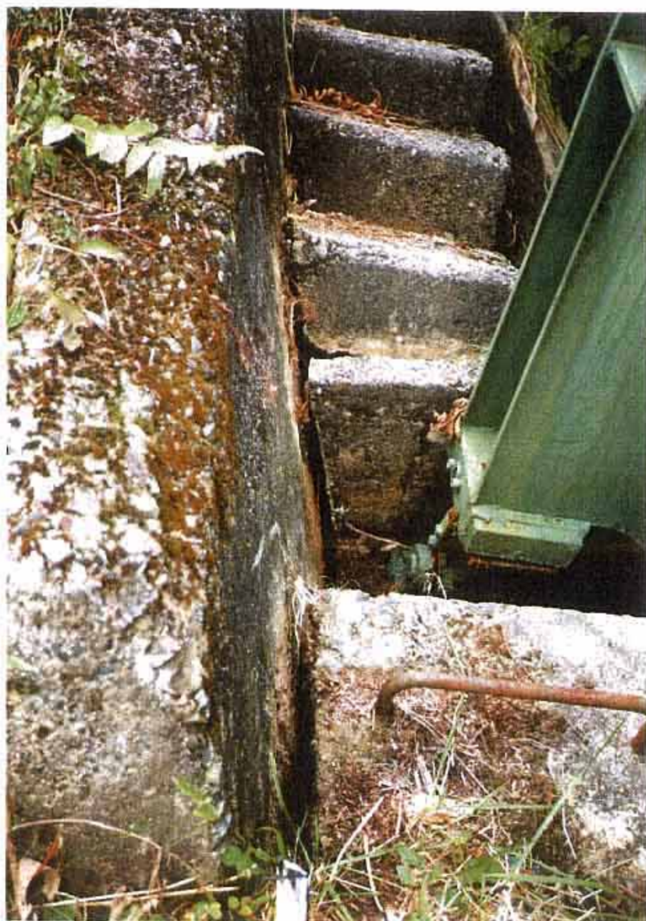
P-41 巡視路階段と擁壁の間に生じた最大 開口幅 5cm の隙間。
