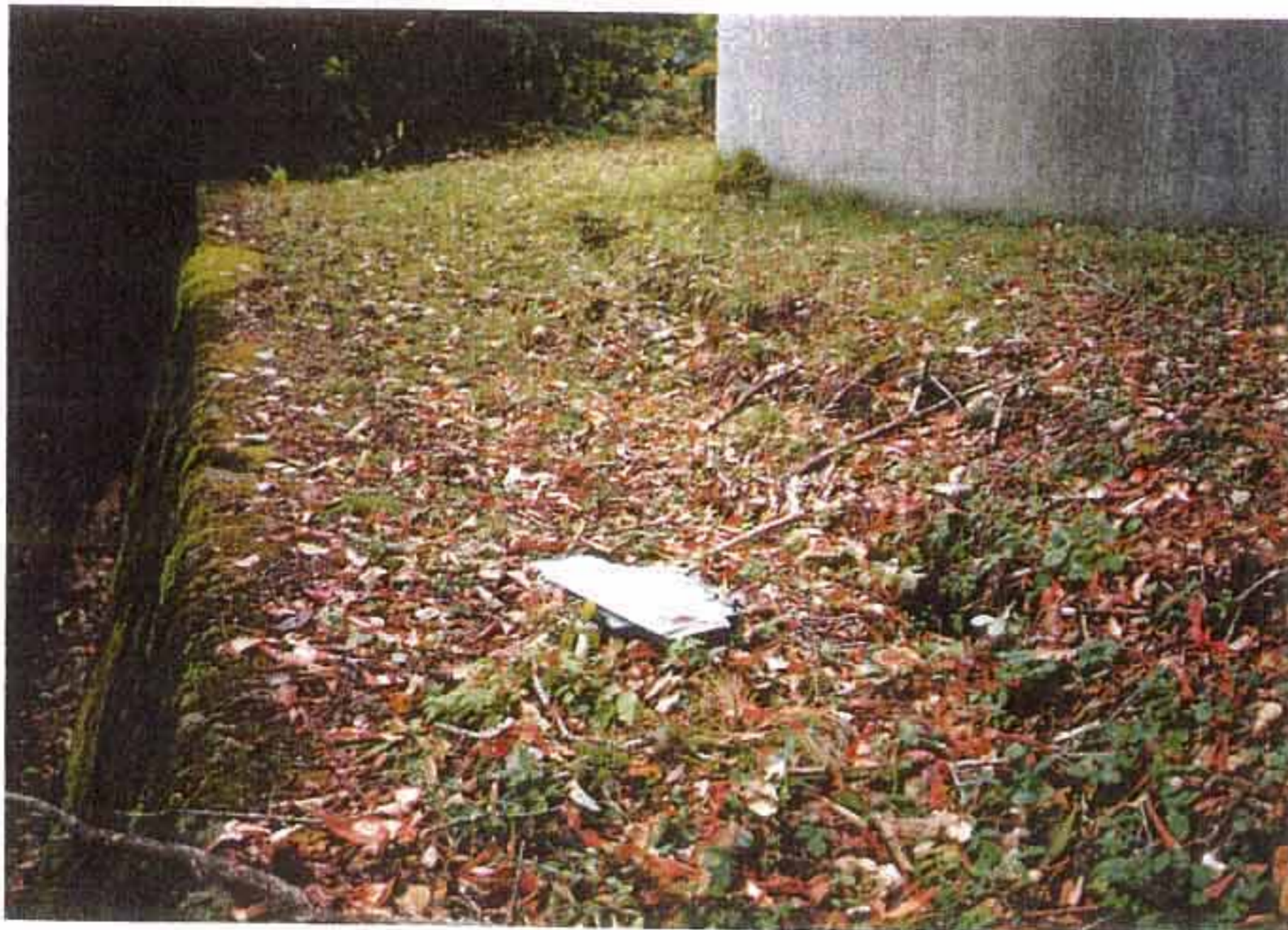
P-33 P-32 のクラックの全景。
