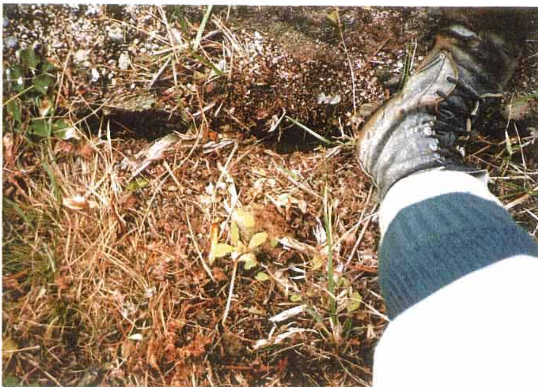
P-15 擁壁と地山(表土)との間に 1~2cm の隙間。
