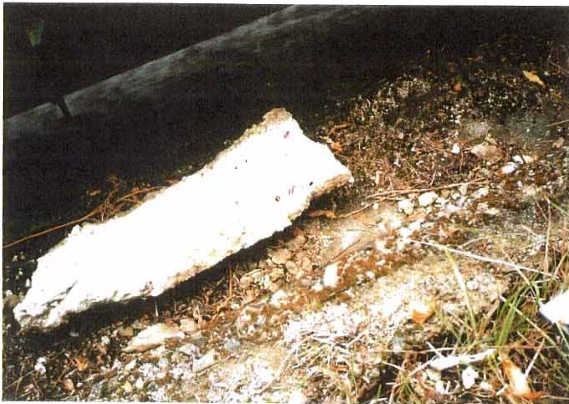
P-14 同上。(分離したコンクリート片)
