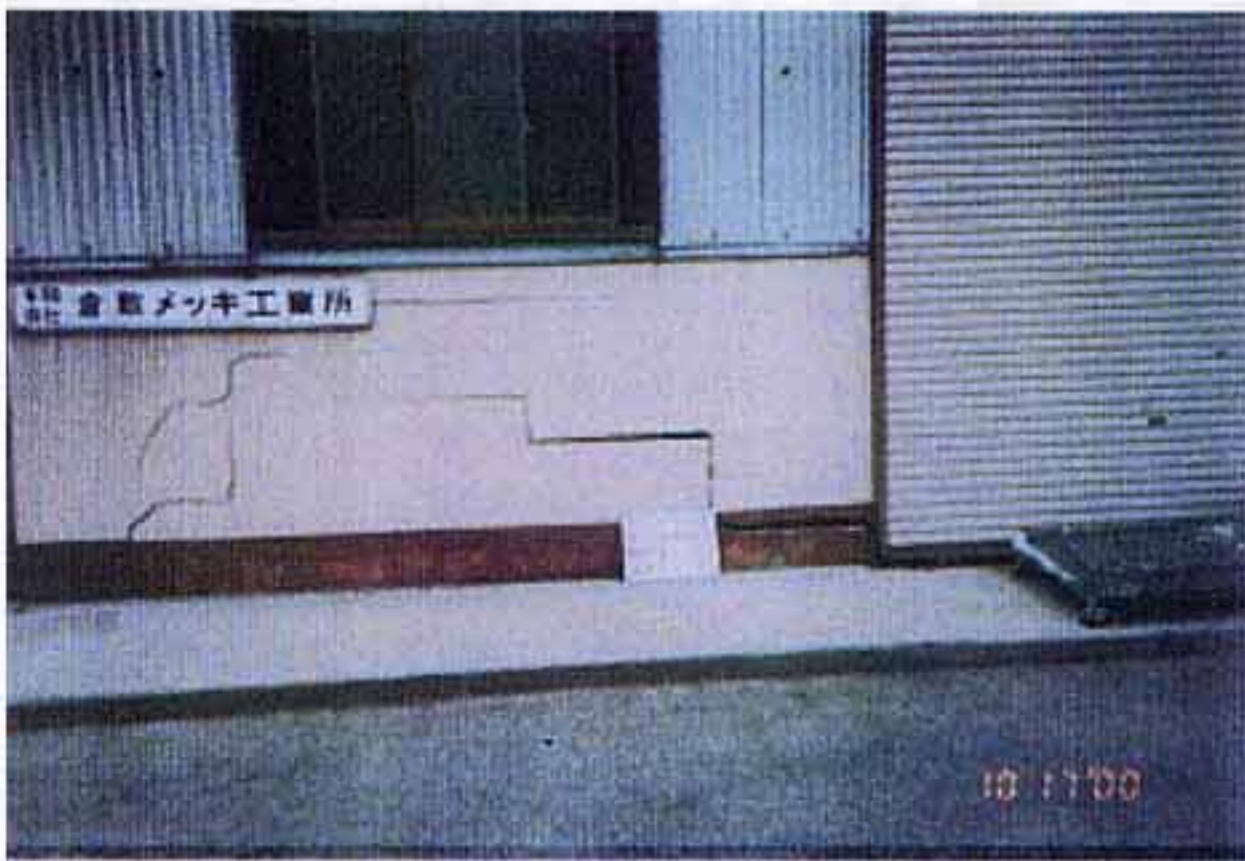
写真4 不同沈下による壁の損傷
