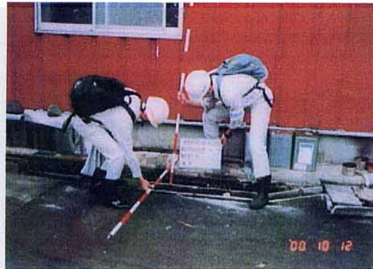
写真5 建物周辺地盤の不同沈下(20 cm)
