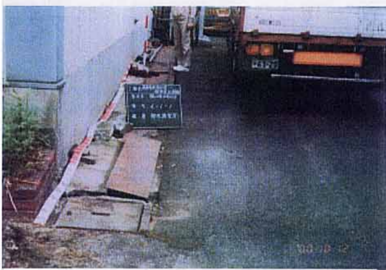
写真1 建物周辺の不同沈下
