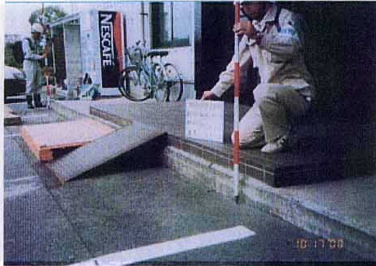
写真5 基礎部周辺の不同沈下(15 cm)
