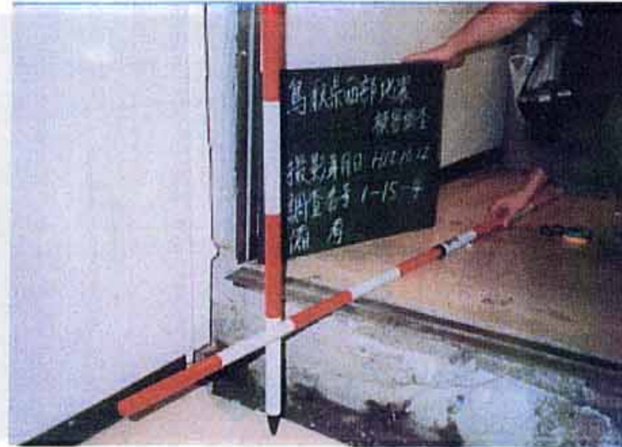
写真2 建物周辺地盤の不同沈下(20 cm)
