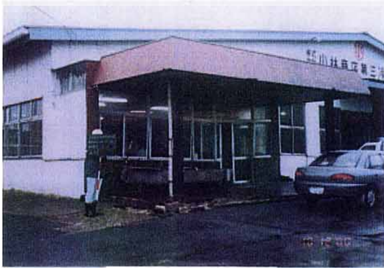
写真1 宅盤の不同沈下
