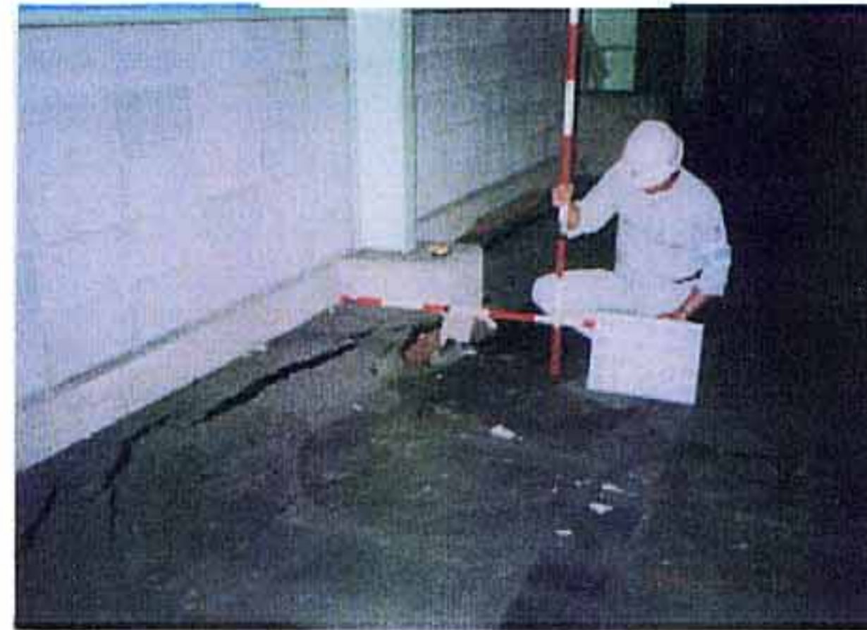
写真5 基礎部周辺の不同沈下(20 cm)
