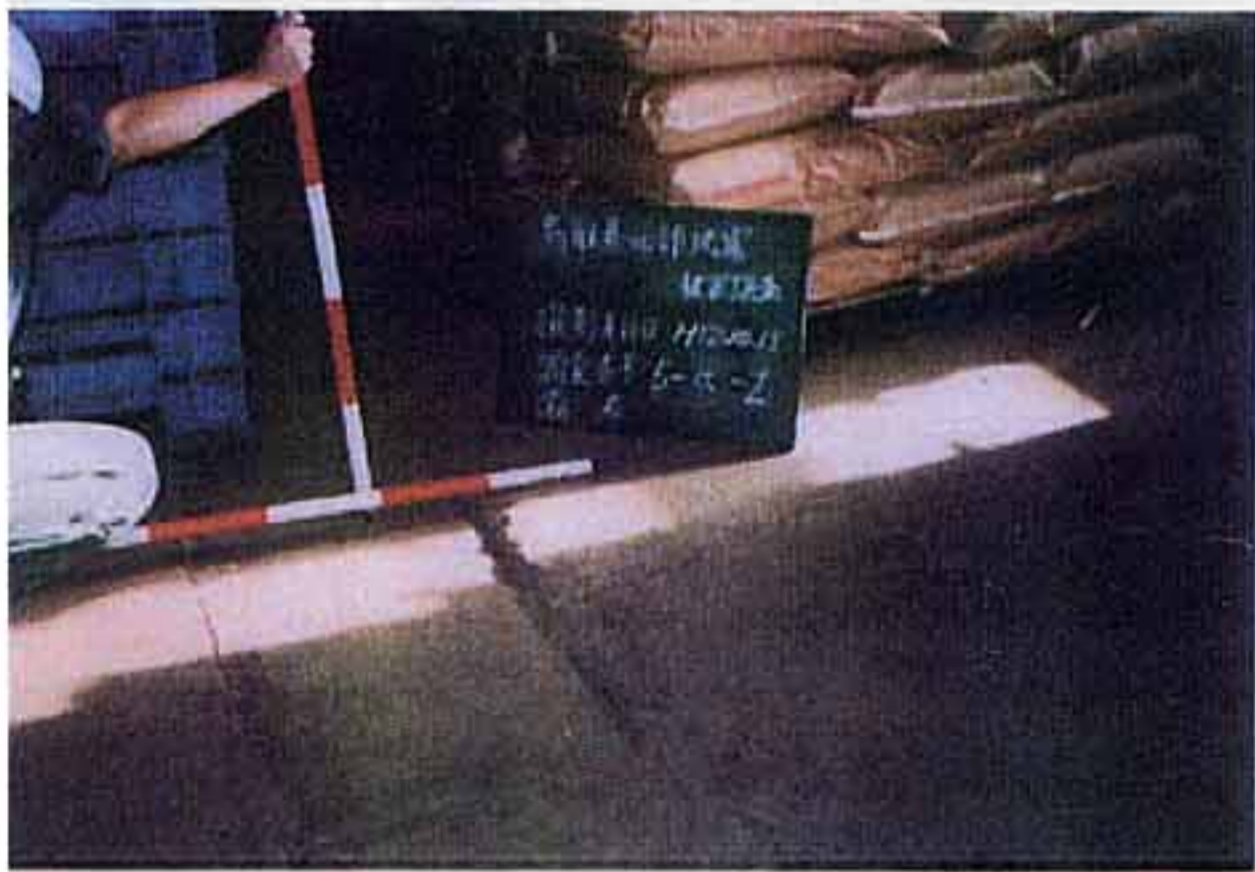
写真4 宅盤の不同沈下による床の段差
