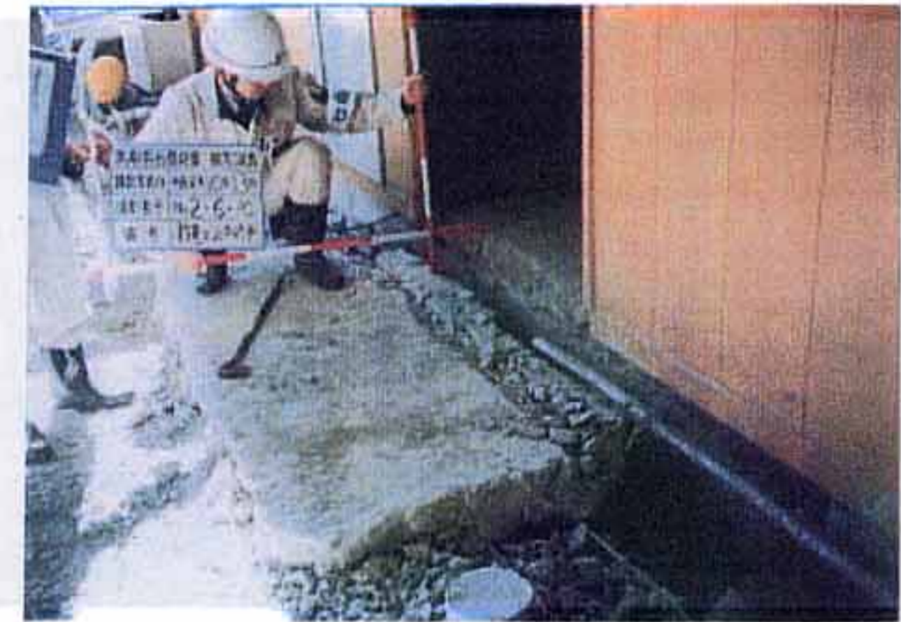
写真3 建物周辺地盤の不同沈下(17 cm)
