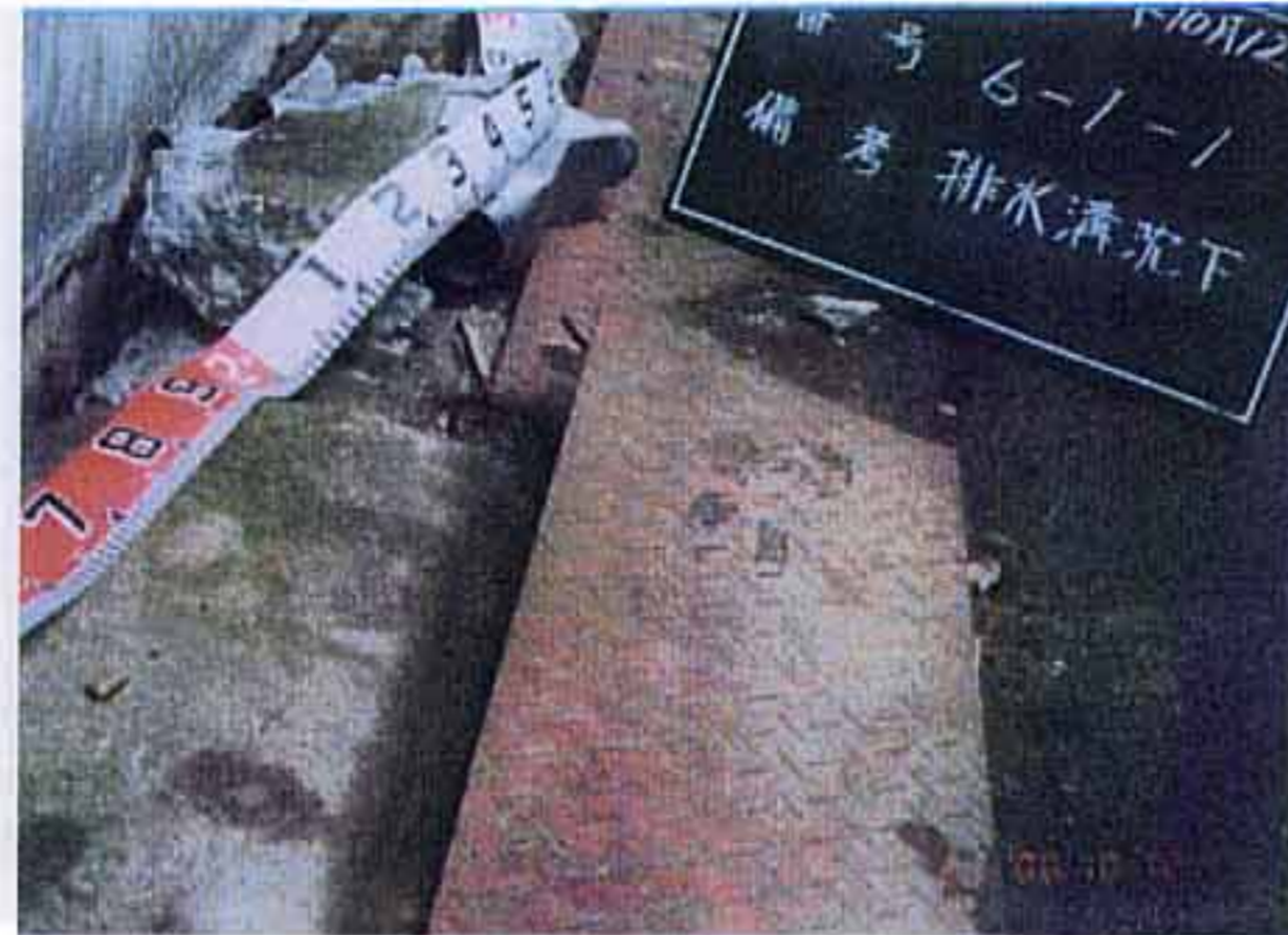
写真2 建物周辺の不同沈下
