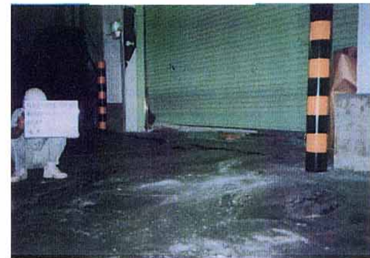
写真6 宅盤の不同沈下
