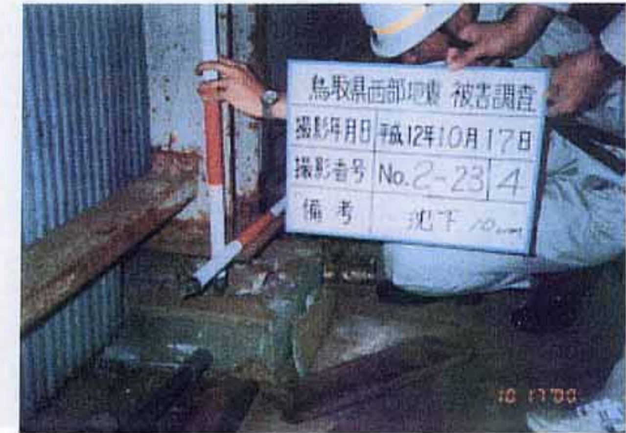
写真3 基礎部周辺の不同沈下
