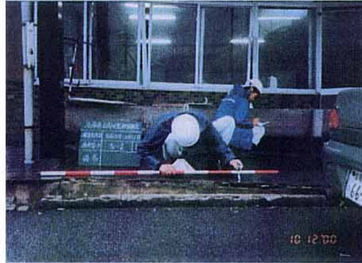
写真2 宅盤の沈下(10 cm)
