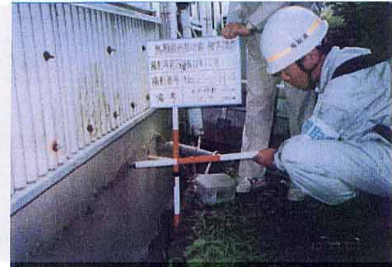
写真6 宅盤の不同沈下及び水平移動
