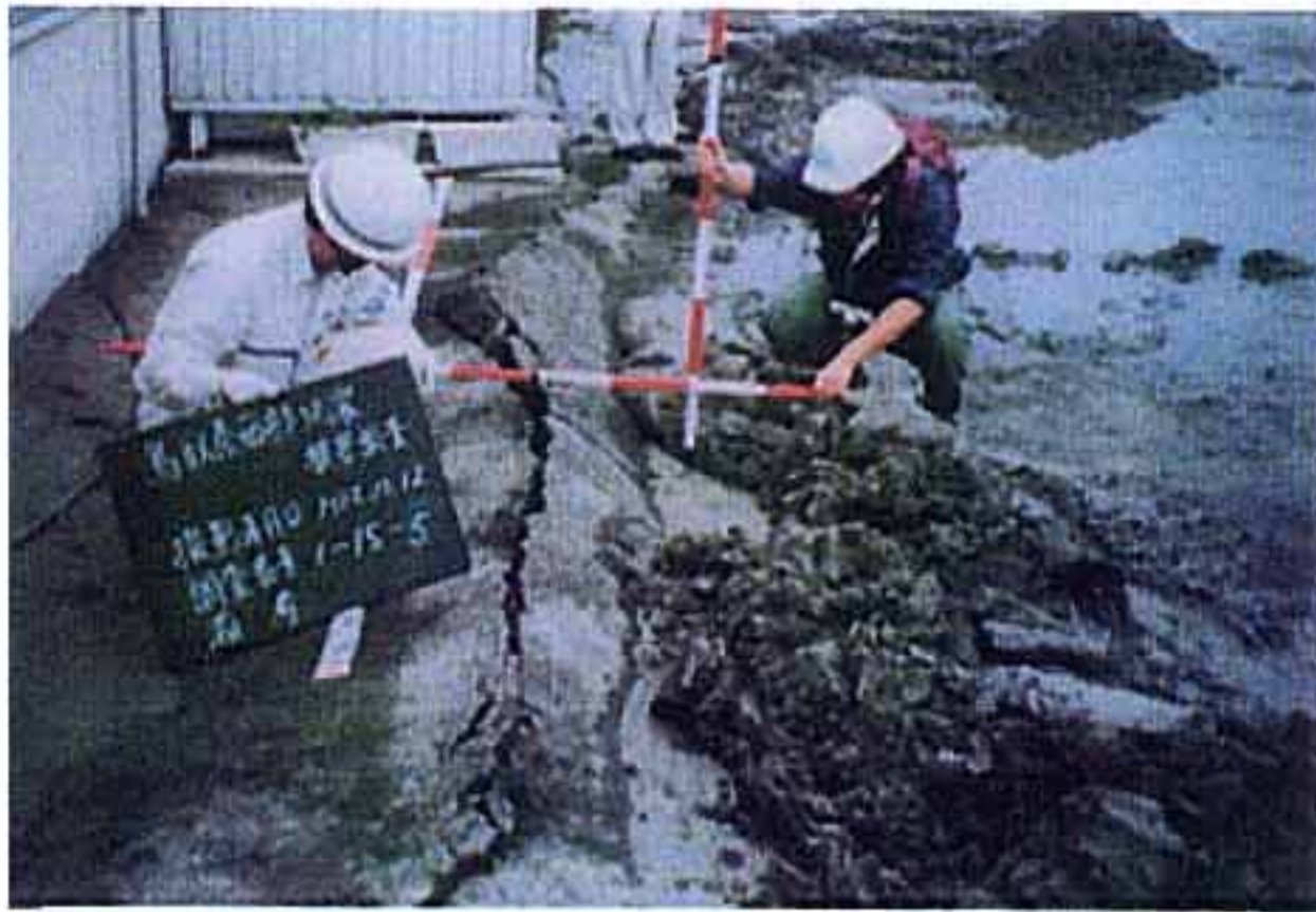
写真1 建物周辺部舗装の隆起及び噴砂
