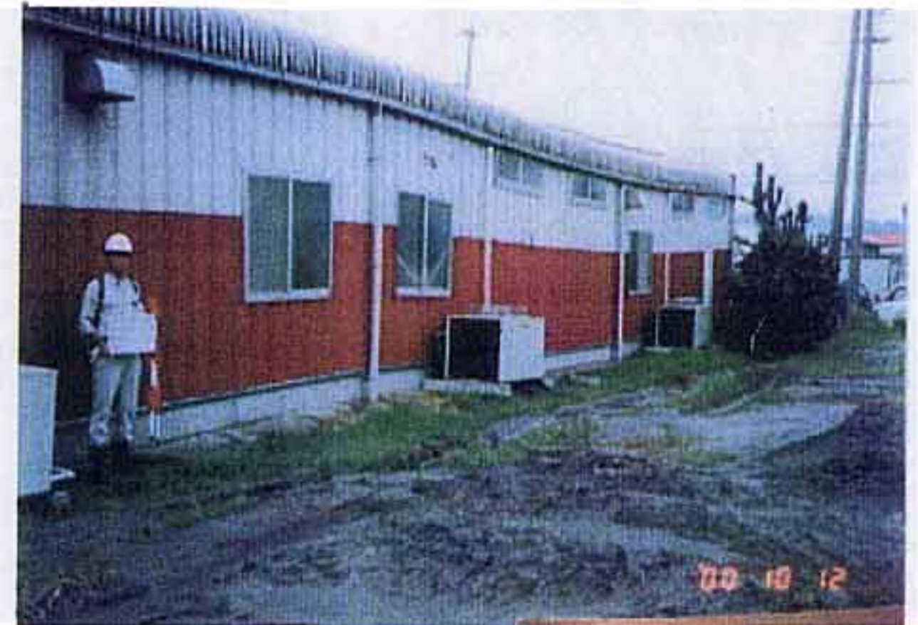
写真6 不同沈下による建物の変形および 建物周辺の噴砂状況
