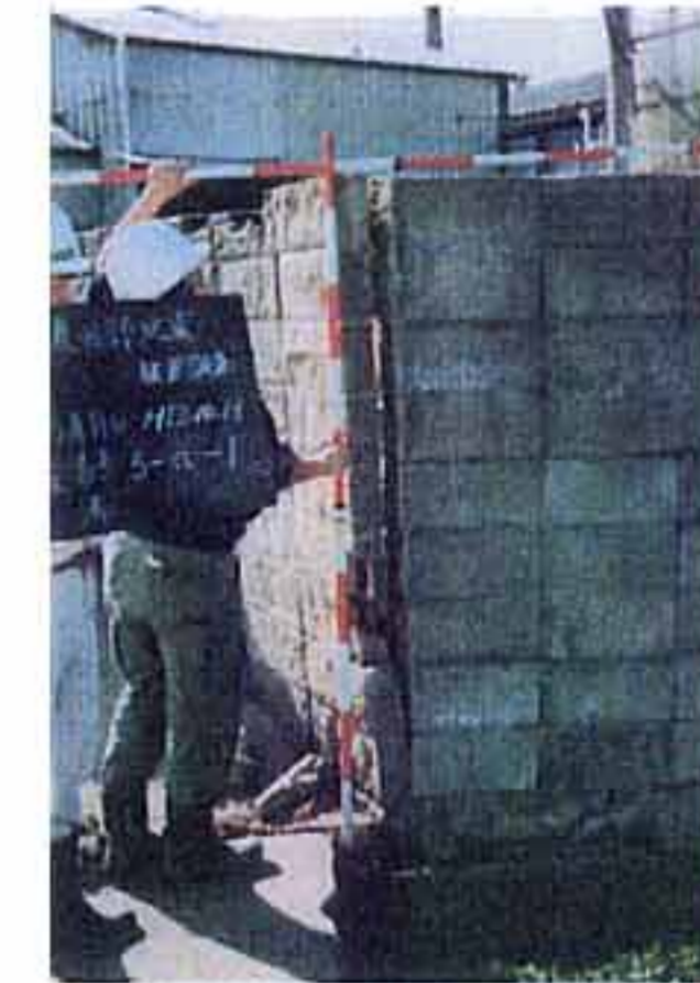
写真3 ブロック塀の傾斜
