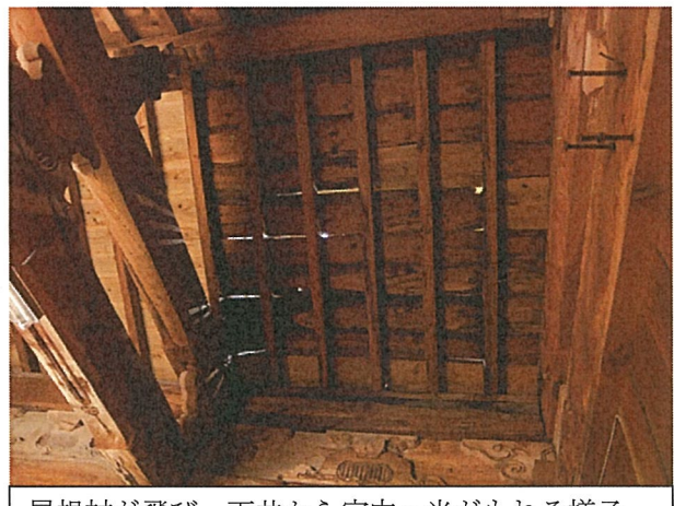
屋根材が飛び、天井から室内へ光がもれる様子
