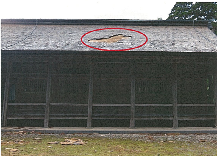
こけら板が飛んだ箇所
