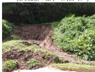
[路肩崩壊及び水路閉塞(大山町)]
