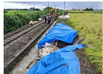
[田の畦畔崩壊(復旧中)(大山町)]
