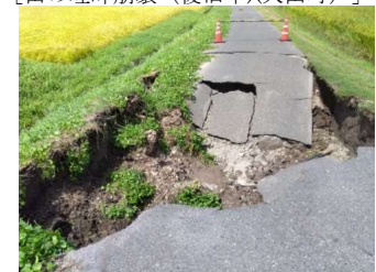
[舗装沈下(通行止め対応)(大山町)]
