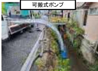
可搬式ポンプ
