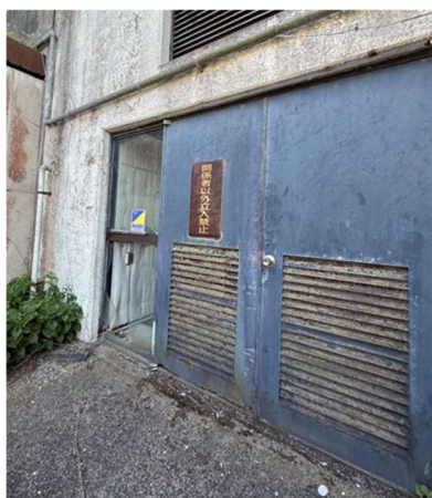
④機械室出入口
