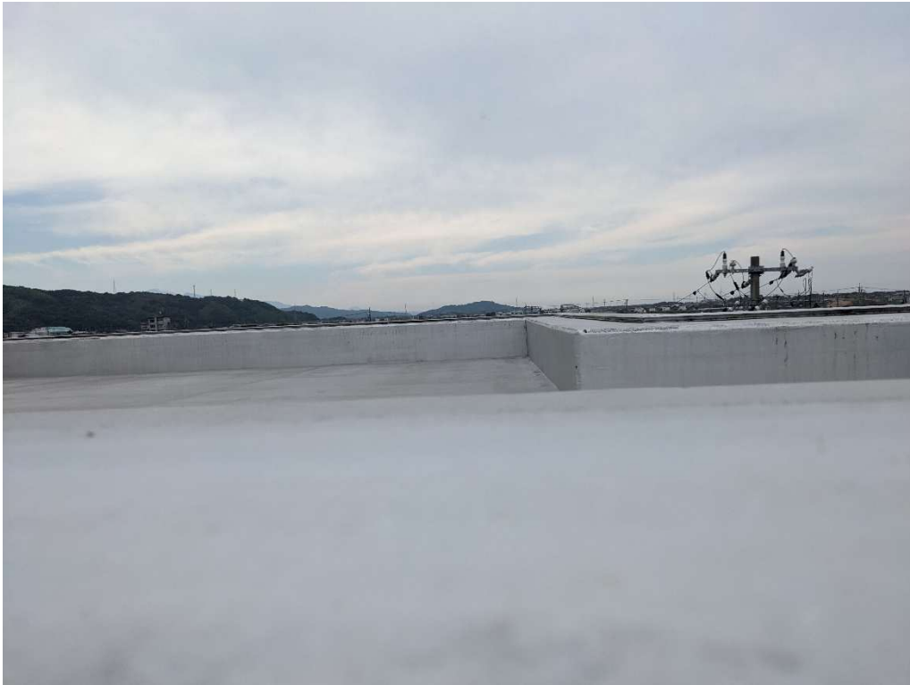
●管理試験棟屋上（塔屋屋上） ※R8 年度防水改修工事中：防水改修前状況
