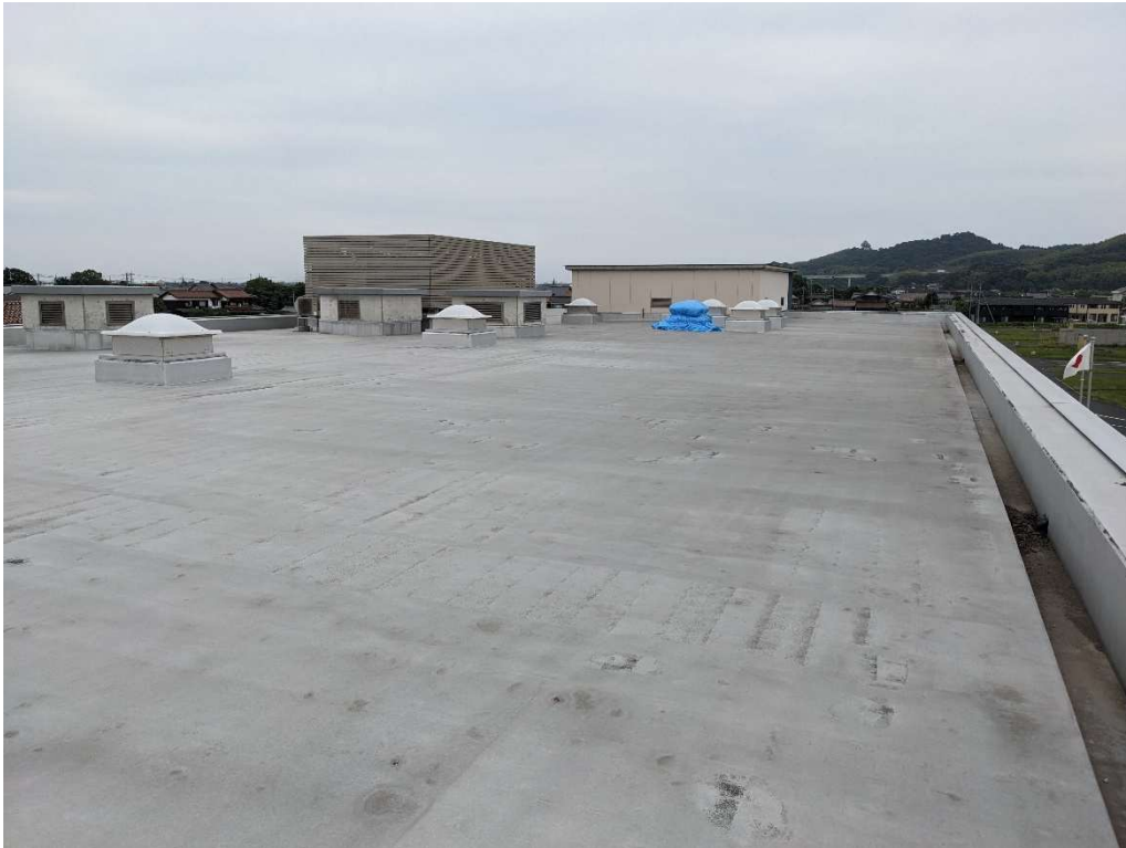
●管理試験棟屋上（南端より北方向を望む） ※R8 年度防水改修工事中：防水改修前状況
