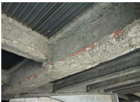
参考：吹付けアスベスト
