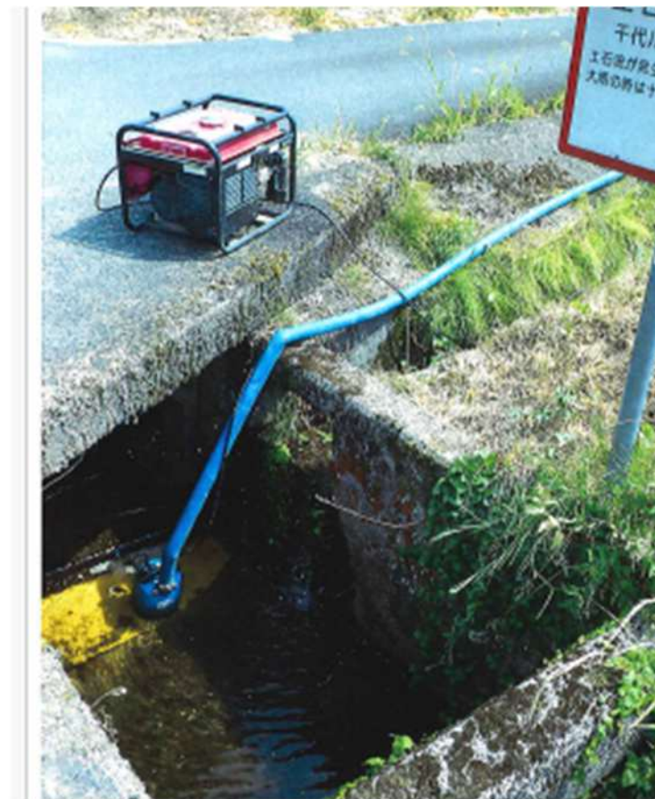
ポンプ取水状況
