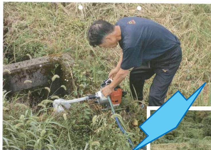
ポンプ取水状況
