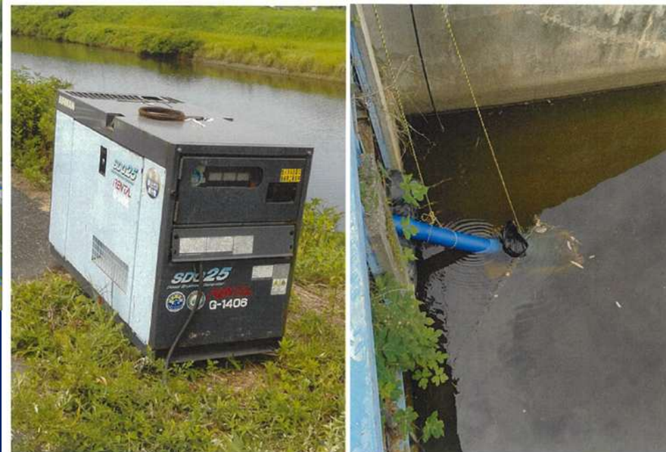
発電機(リース)
