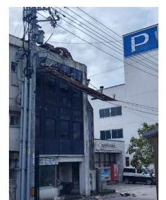
看板の電線への影響(鳥取市)
