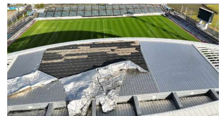
バードスタジアムの被害(鳥取市)
