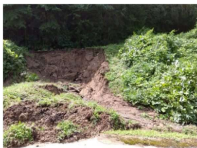
路肩崩壊及び水路閉塞(大山町)
