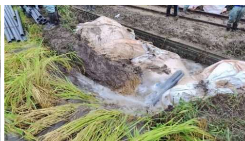
畦畔崩壊(大山町)
