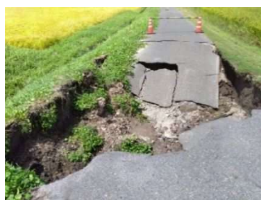
農道陥没(大山町)
