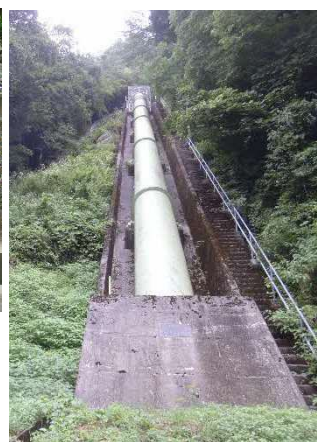
水路[水圧鉄管] (佐治発電所)
