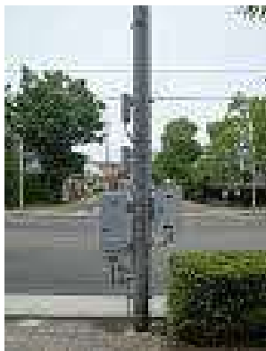
交通信号機 （制御機）
