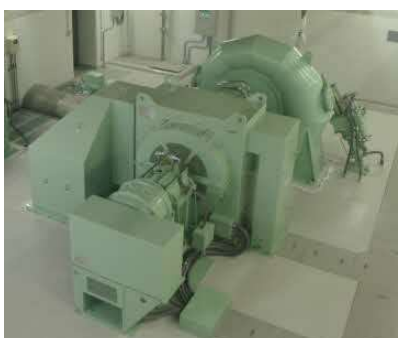
機械[発電機] (袋川発電所)
