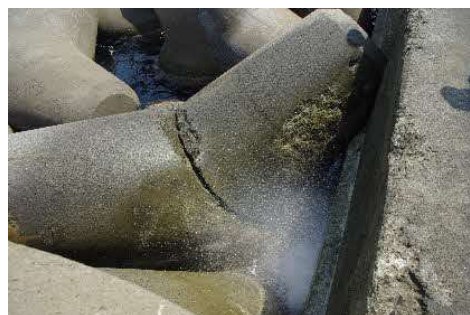
外郭施設の劣化状況 (消波ブロックのひび割れ)
