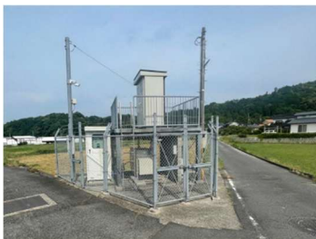
中継ポンプ場 (若土ポンプ場)
