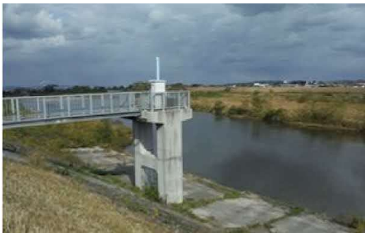
取水施設 [取水施設] (日野川工水)
