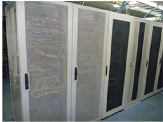
通信機器収容ラック全景（NOC内）
