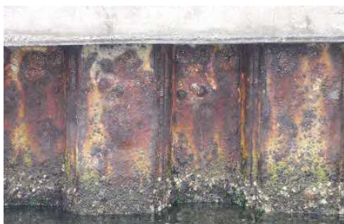
係留施設の劣化状況 (汀線付近の劣化)
