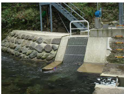
水路[取水口] (私都川発電所)
