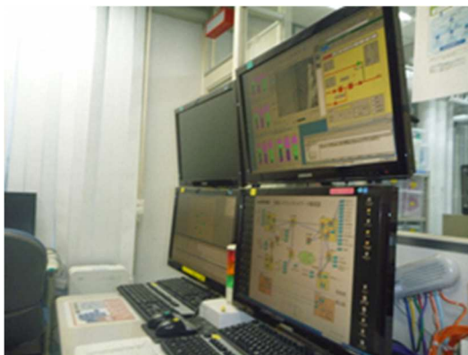
光監視装置（ハイウェイ管理センター内）
