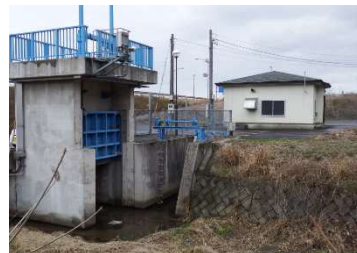
倉田排水機場
