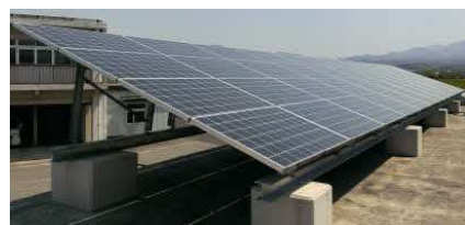
太陽電池パネル[太陽電池パネル] (企業局西部事務所太陽光発電所)
