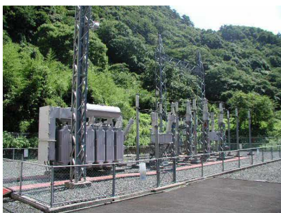
電線路[送電設備] (佐治発電所)
