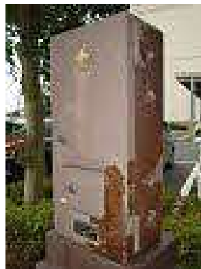
交通信号機（制御機） の老朽化状況
