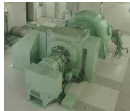
発電機（袋川発電所）
