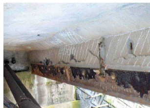
▲ 主桁の損傷状況
