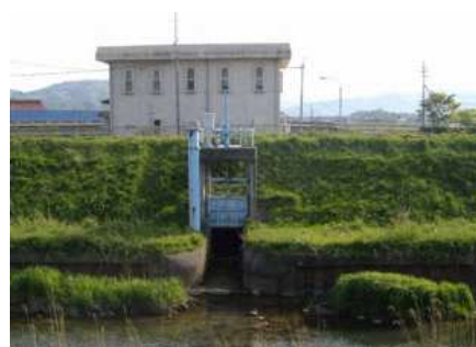
排水機場（西大路排水機場）
