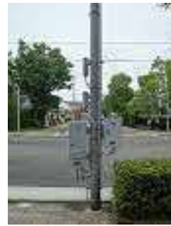
交通信号機（制御機）
