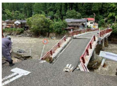
▲ 護岸・橋梁の破損（鳥取市佐治町） 出典：鳥取県ホームページ
