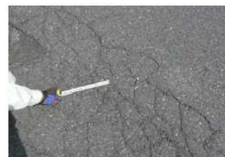
▲ 舗装のひび割れ
