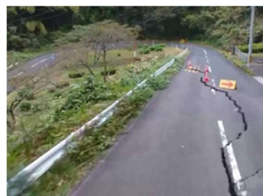
▲ 道路の陥没・亀裂（三朝町） 出典：鳥取県ホームページ
