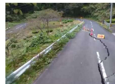
▲ 道路の陥没・亀裂 (三朝町)
