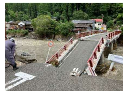
▲ 護岸・橋梁の破損 (鳥取市佐治町)
