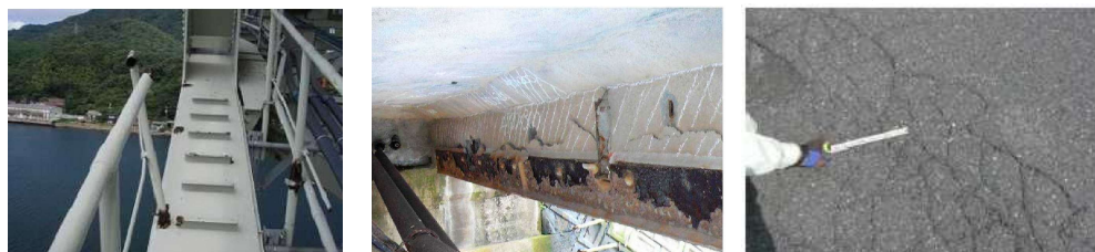
▲ 監査路の腐食・破断状況 ▲ 主桁の損傷状況 ▲ 舗装のひび割れ
