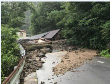
県道鳥取鹿野倉吉線 (三朝町吉原) の被災状況
