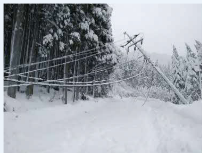
電柱倒壊の状況 (若桜町来見野)
