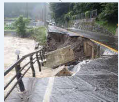
国道 373 号 (智頭町福原) の被災状況
