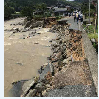
県道麻生国府線 (八頭町福地) の被災状況
