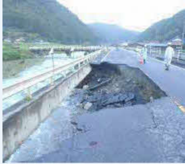
国道 180 号 (日野町濁谷) の被災状況
