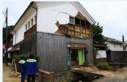
白壁土蔵群の建物被害
