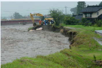
米子市河岡(佐陀川)の被災状況
