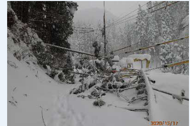
電柱倒壊の状況 (八頭町姫路)
