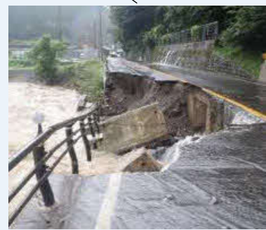
国道 373 号 (智頭町福原) の被災状況
