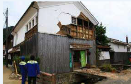
白壁土蔵群の建物被害
