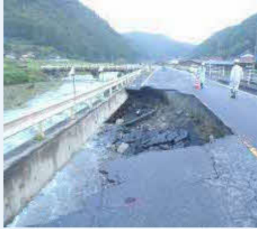
国道 180 号 (日野町濁谷) の被災状況
