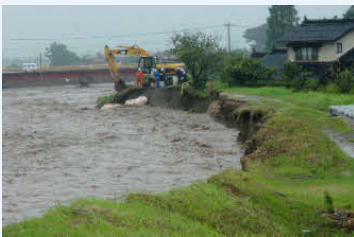
米子市河岡(佐陀川)の被災状況
