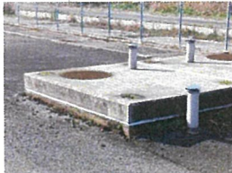
補水槽周り舗装沈下(彦名)
