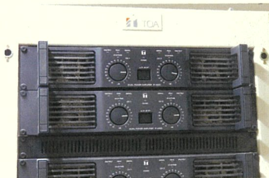
放送室 放送アンプ 拡大
