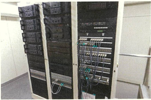
放送室 放送アンプ 全体
