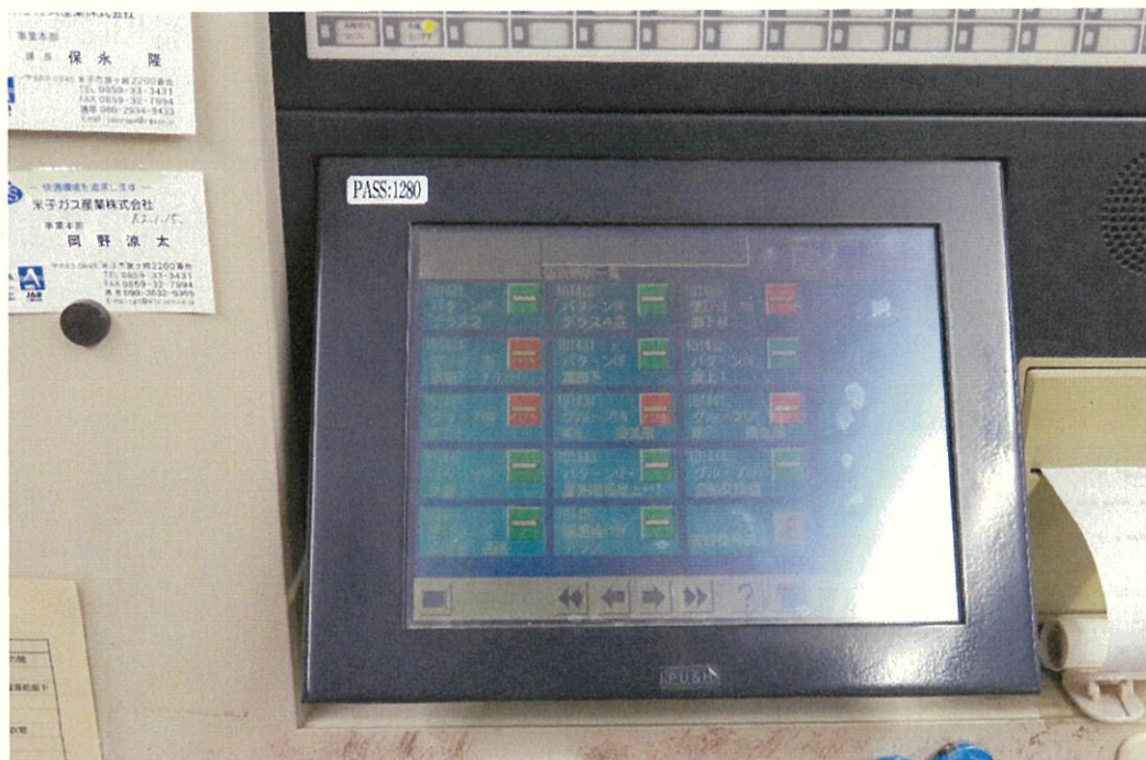
タッチパネル部分 拡大
