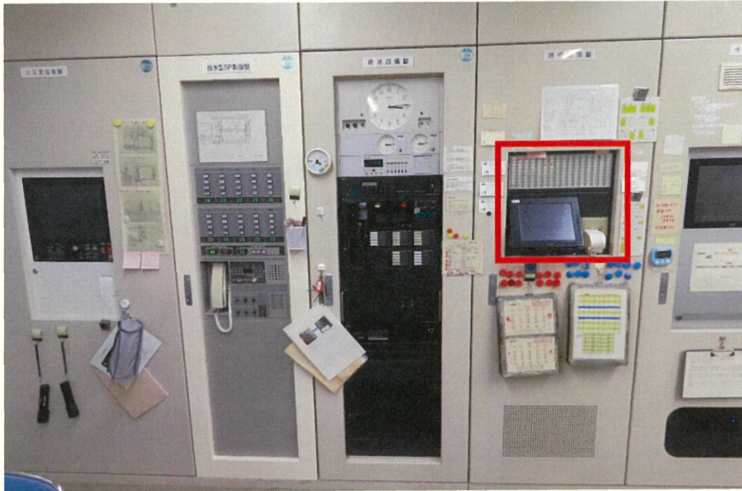
非常放送用設備 全体
