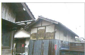
北栄町西園地内の住家と倉庫。応急度判定で危険とされていた
