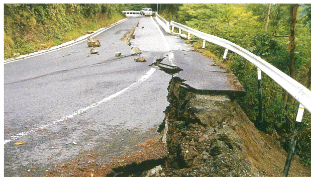
江府町地内 岸本江府線における路肩の崩落と道路の亀裂
