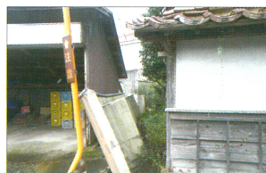
隣家に寄りかかるブロック塀(湯梨浜町小鹿谷地内)
