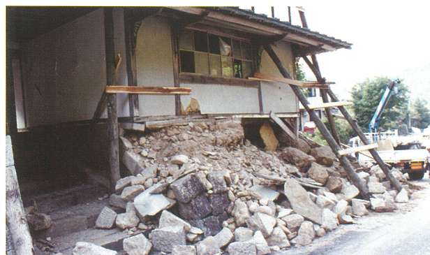
崩れ落ちた石垣
