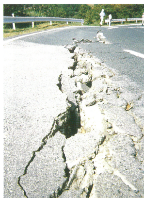
溝口町(現伯耆町)地内の日野溝口線における道路の亀裂
