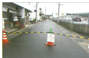
道路の陥没により通行止めとなったJR松崎駅前
