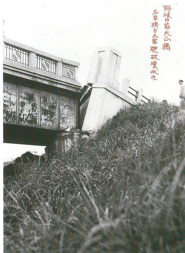
野坂川筋大正橋 道路面が沈下したことに伴い、右岸橋台がその方向に引っ張られたもの。 (「鳥取地方震災被害調査報告書」)
