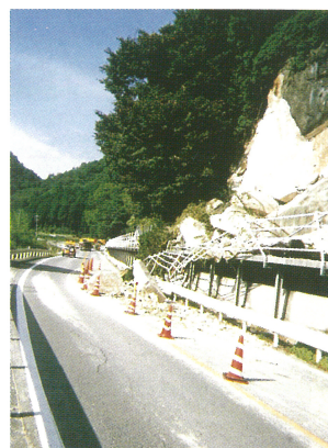
日野町地内の国道180号線におけるのり面の崩落
