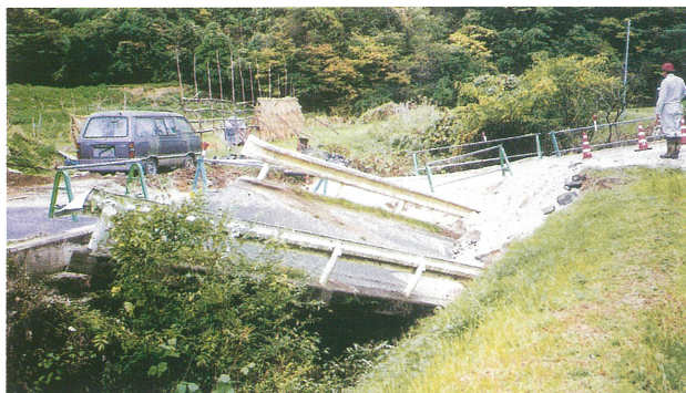
西伯町(現南部町)地内 地盤のずれにより崩れた橋
