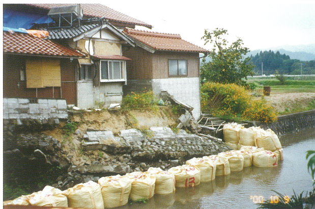
会見町(現南部町)地内 朝鍋川の護岸崩壊と民家の沈下
