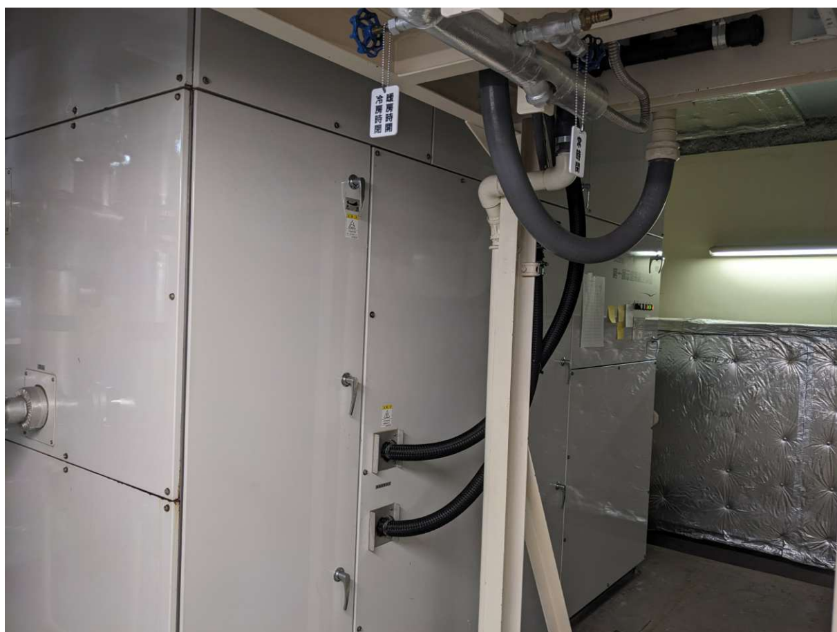
⑦-4 AC216第1特別展示室系統_蒸氣管
