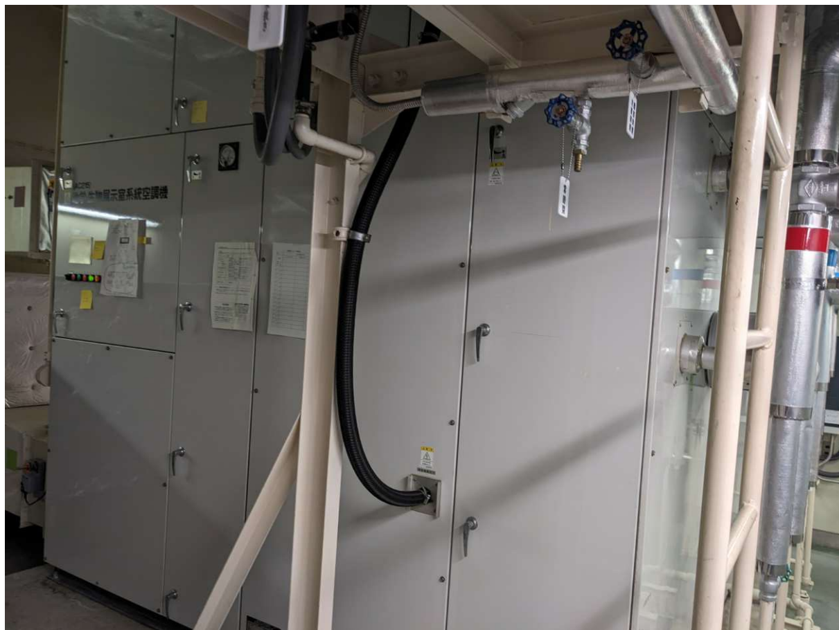
⑥-4 AC215第1展示活動室系統_蒸氣加湿器配管
