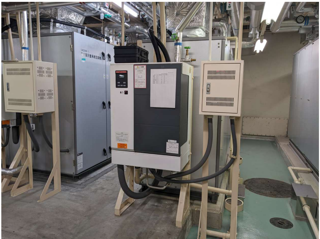
②-2 AC208-2第3展示活動室系統_蒸氣加濕器設置狀況
