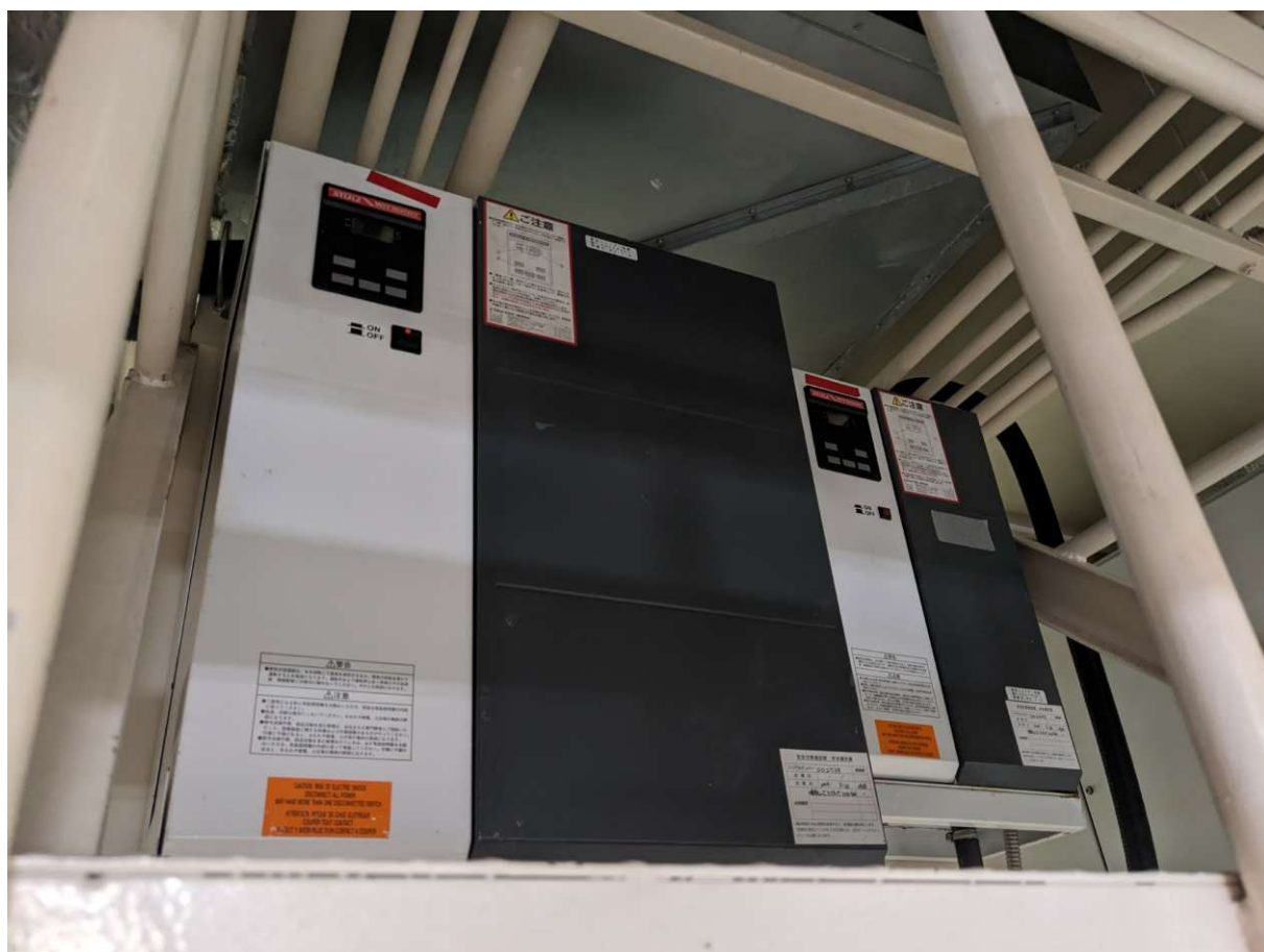
⑦-3 AC216第1特別展示室系統_蒸氣加湿器(左側)
