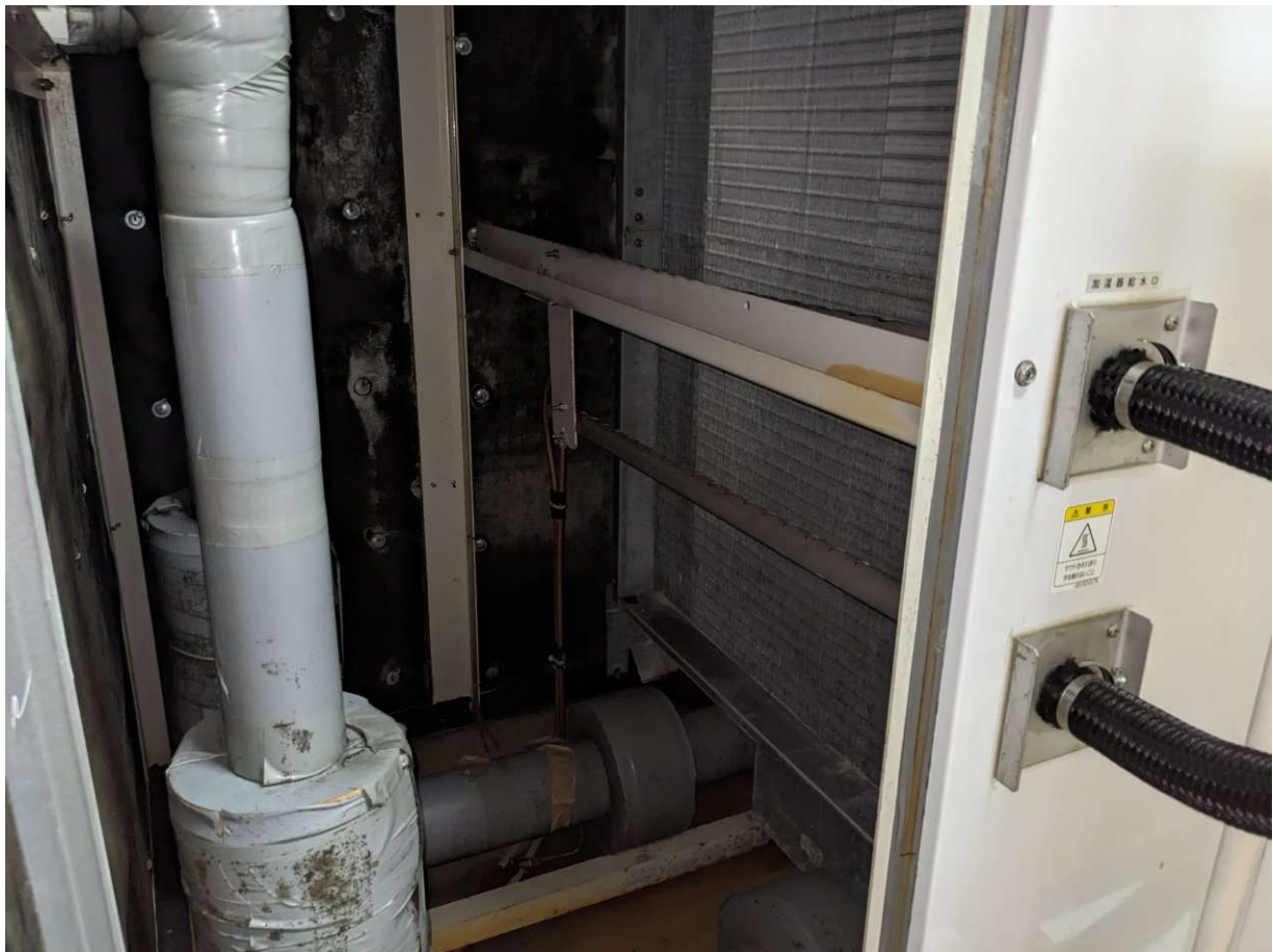
⑤-3 AC214第2特別展示室系統_空調機内蒸気噴霧管周り状況
