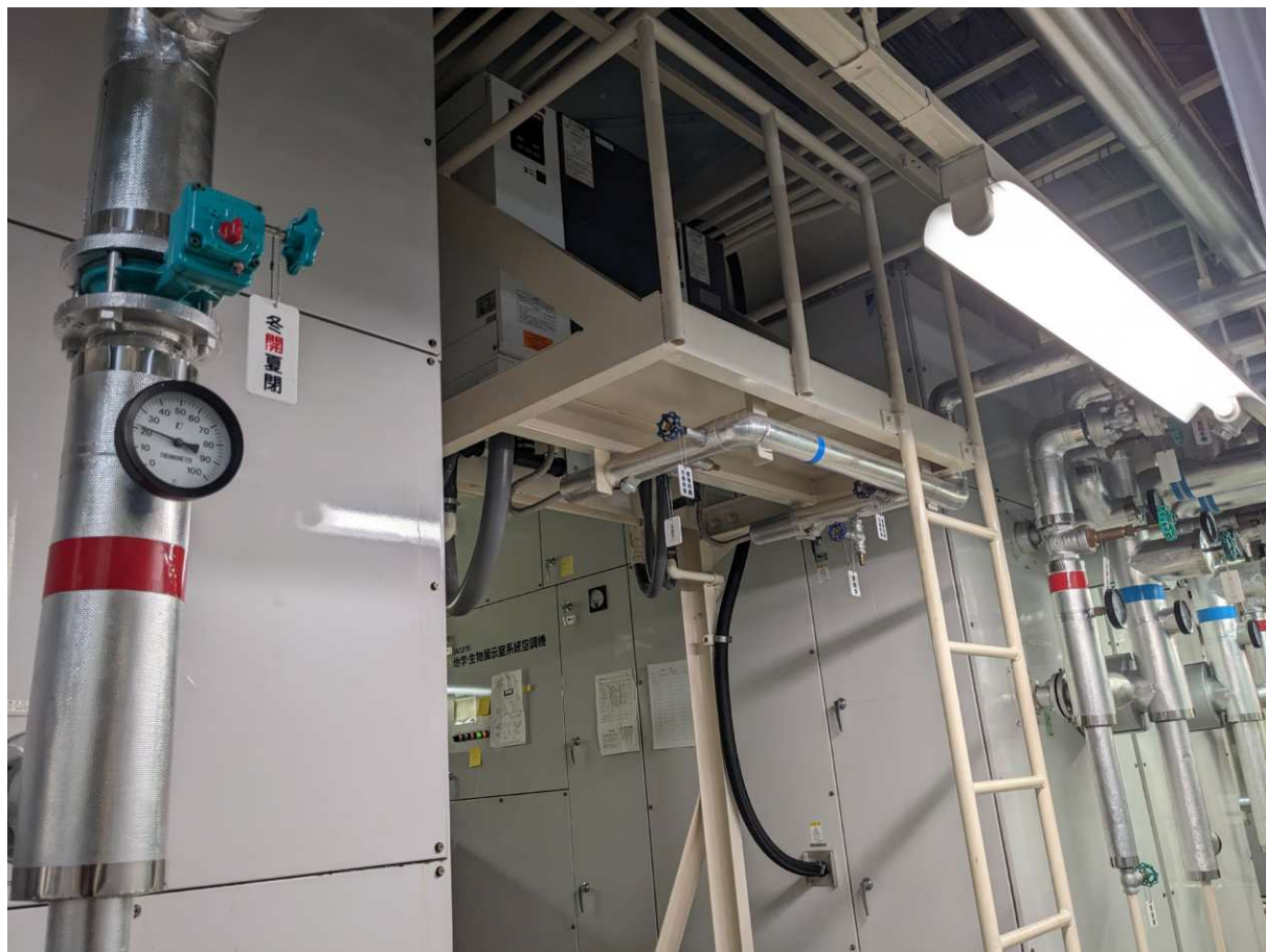
⑦-1 AC216第1特別展示室系統_蒸気加湿器用ステージ(⑥AC215と共用)
