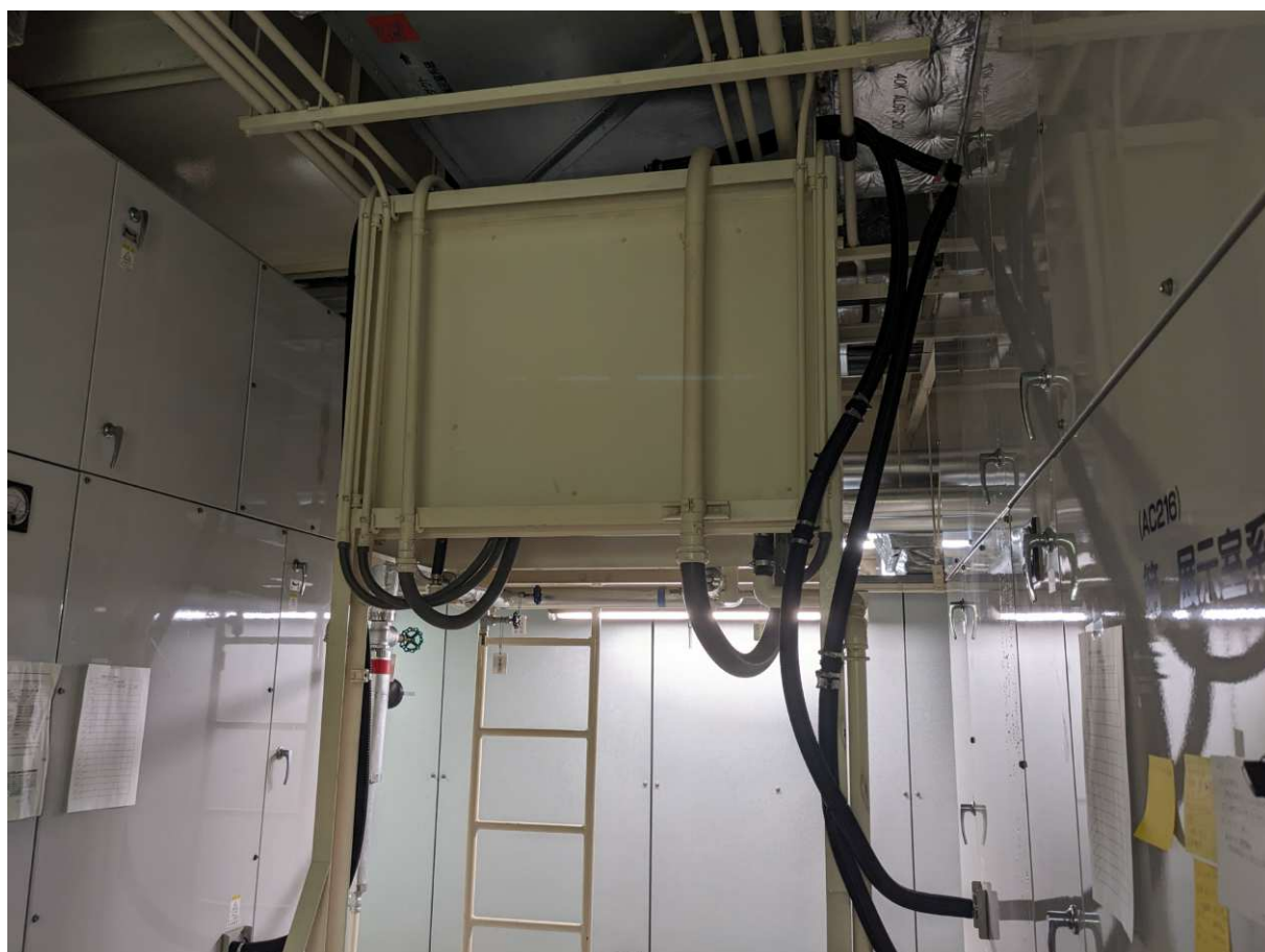
⑥-2 AC215第1展示活動室系統_蒸気加湿器用ステージ(⑦AC216と共用)
