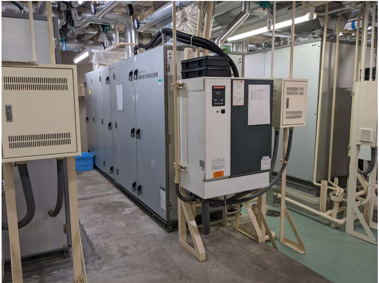
②-1 AC208-2第3展示活動室系統_蒸氣加濕器設置狀況
