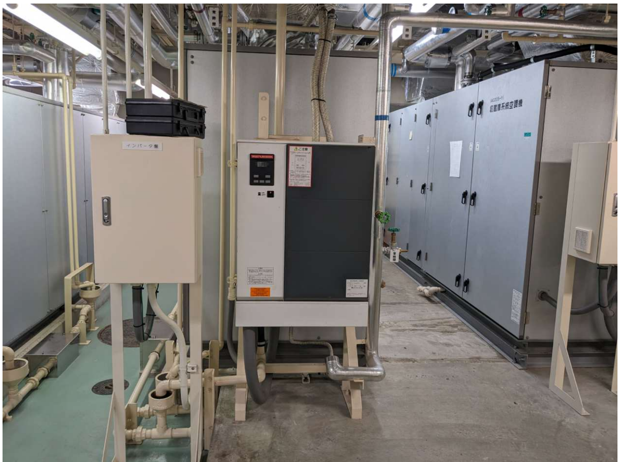
①-2 AC205-2史料書庫系統_蒸気加湿器設置状況
