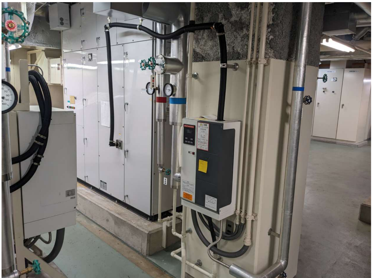
④-1 AC213資料保管庫系統_蒸気加湿器設置状況
