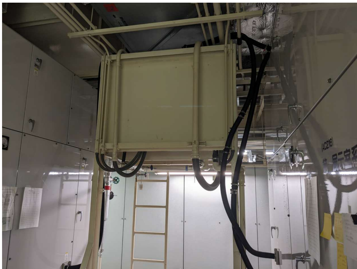
⑦-2 AC216第1特別展示室系統_蒸気加湿器用ステージ(⑥AC215と共用)
