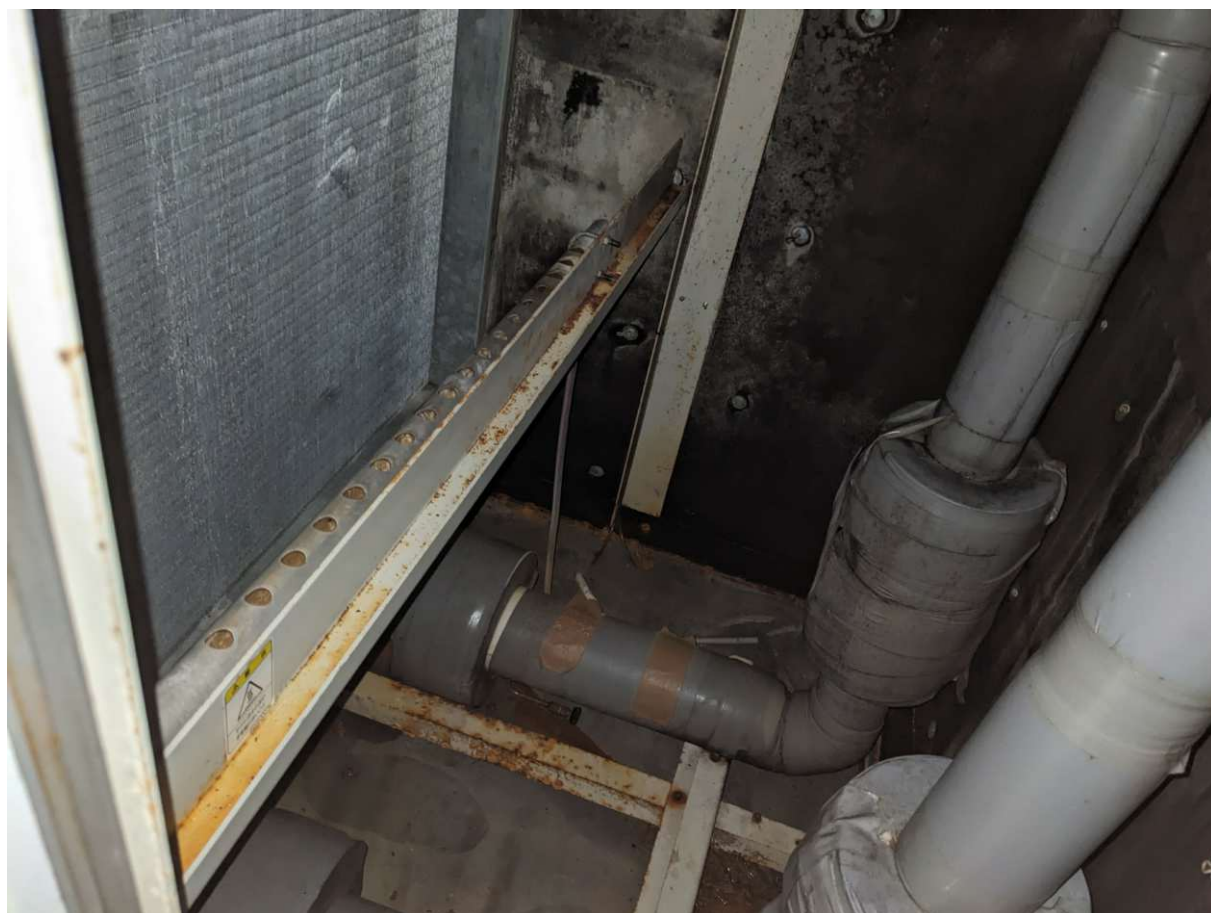
⑥-5 AC215第1展示活動室系統_蒸氣噴霧管周り状況
