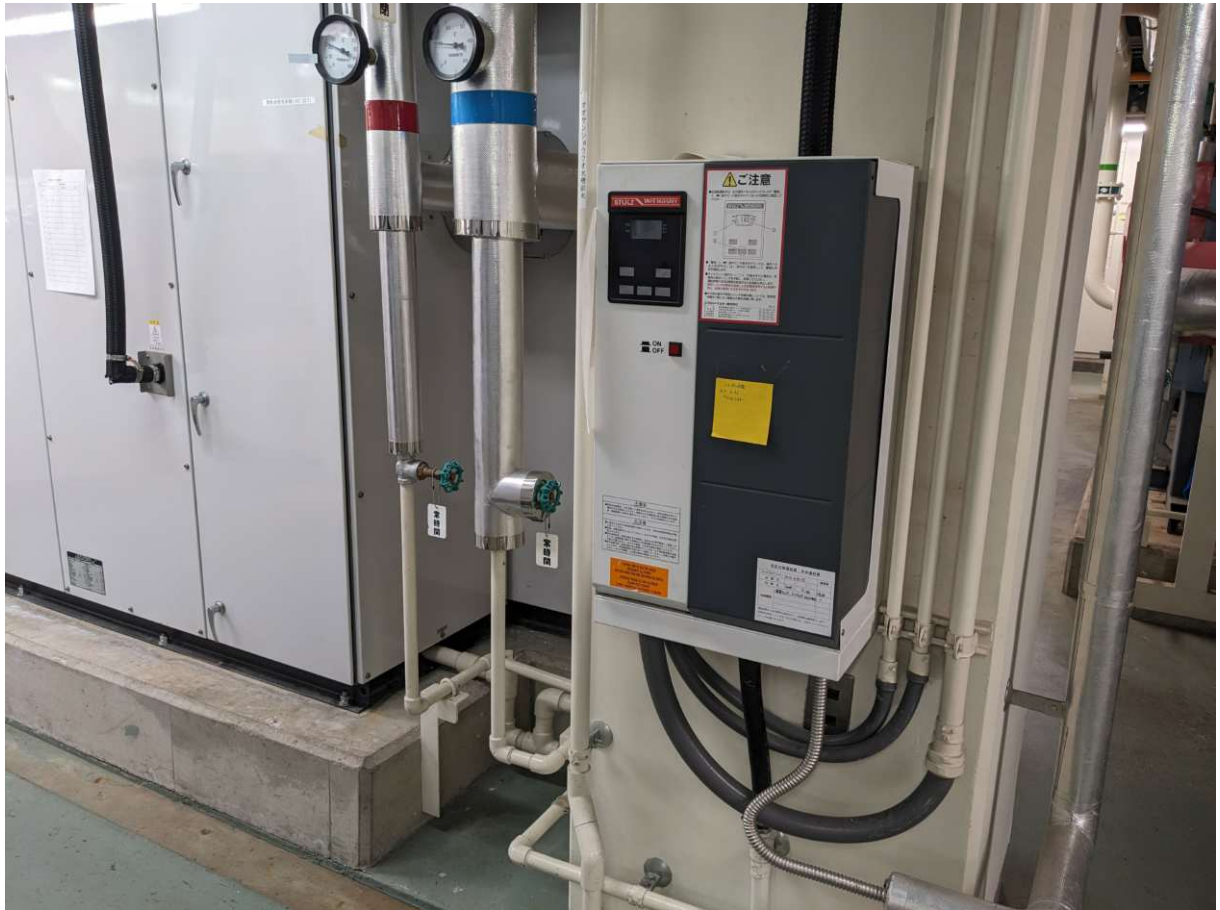
④-2 AC213資料保管庫系統_蒸気加湿器設置状況
