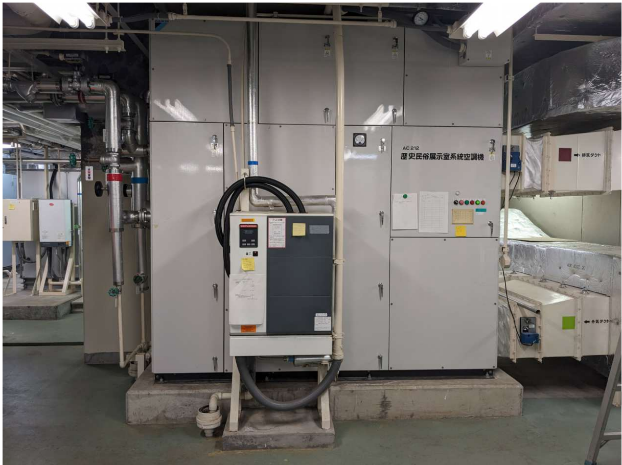
③-1 AC212第2展示活動室系統_蒸気加湿器設置状況
