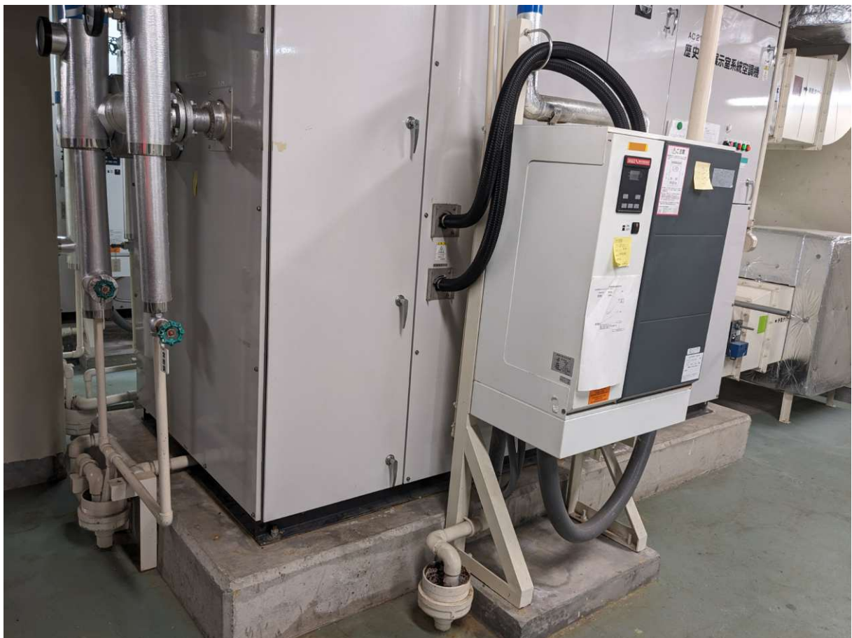
③-2 AC212第2展示活動室系統_蒸気加湿器設置状況
