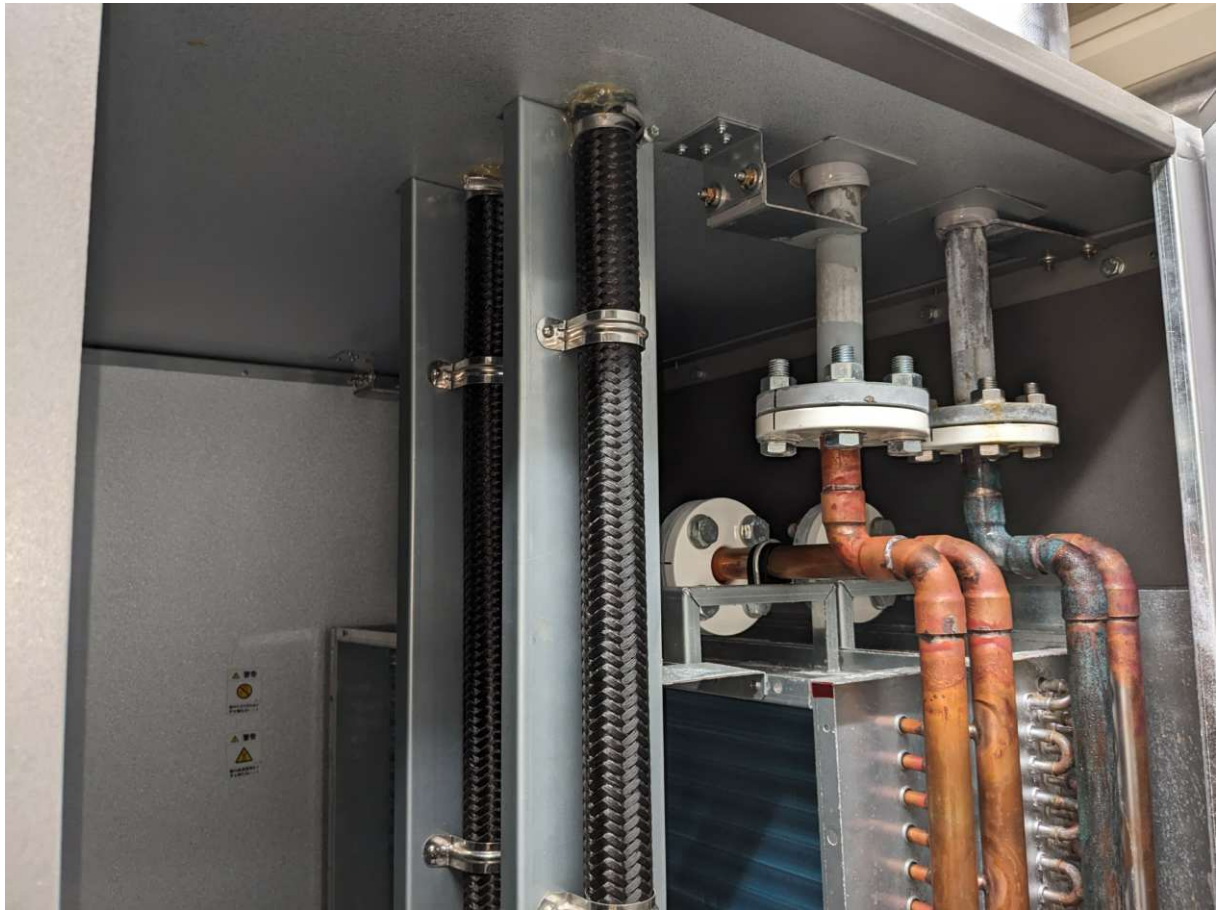
①-3 AC205-2史料書庫系統_蒸気噴霧管周り状況
