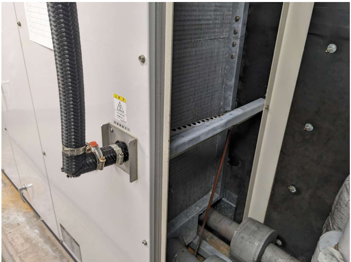
④-3 AC213資料保管庫系統_空調機内蒸気噴霧管周り状況
