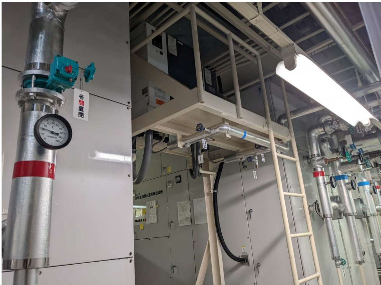
⑥-1 AC215第1展示活動室系統_蒸気加湿器用ステージ(⑦AC216と共用)
