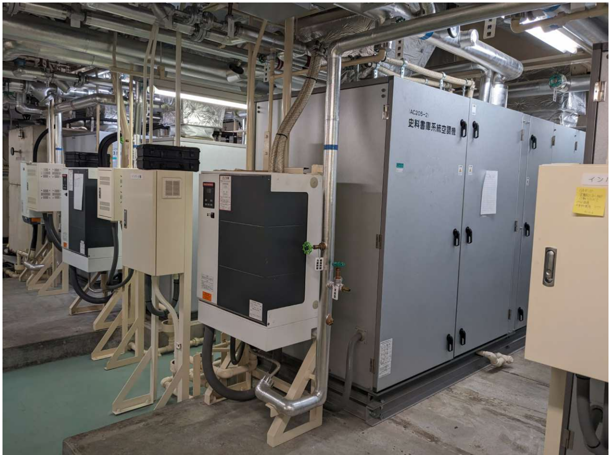
①-1 AC205-2史料書庫系統_蒸気加湿器設置状況
