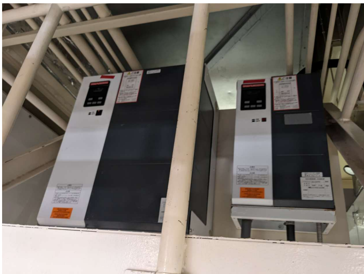
⑥-3 AC215第1展示活動室系統_蒸気加湿器(右側)
