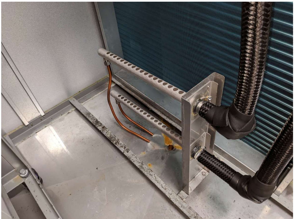
①-4 AC205-2史料書庫系統_蒸気噴霧管周り状況
