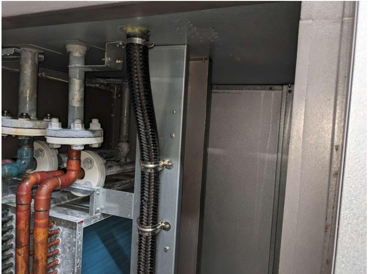
②-3 AC208-2第3展示活動室系統_蒸氣噴霧管周り状況
