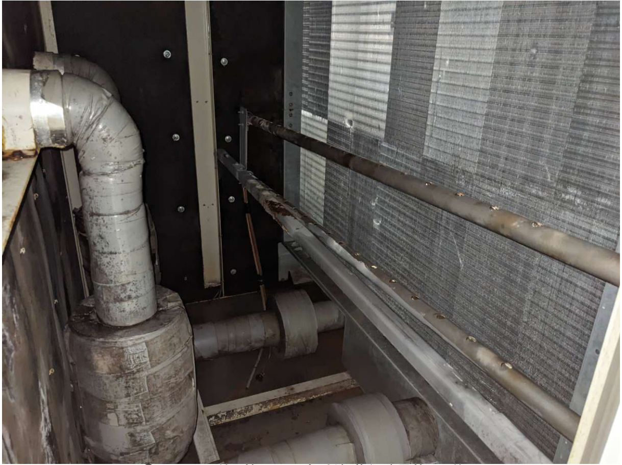
⑦-5 AC216第1特別展示室系統_蒸気噴霧管周り状況
