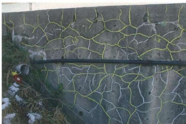
アルカリシリカ反応の典型的なひび割れ の特徴として、亀甲状のひび割れが発生 することが多い。
