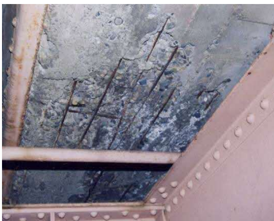
鉄筋かぶりが少ない場合、塩分がコンクリート内に浸透して鉄筋が腐食しやすい。
