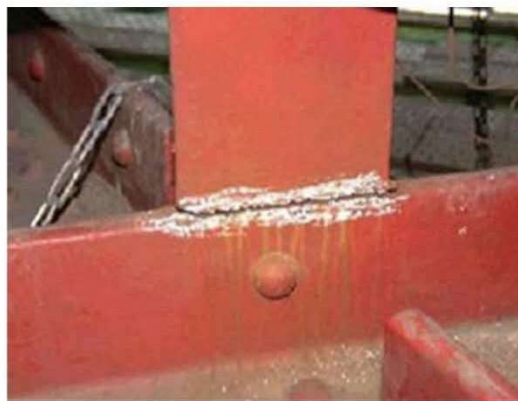
吊り材が破断している。
