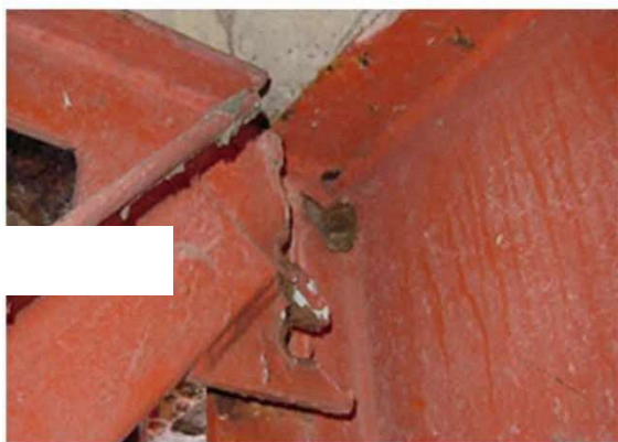
対傾構が破断している。
