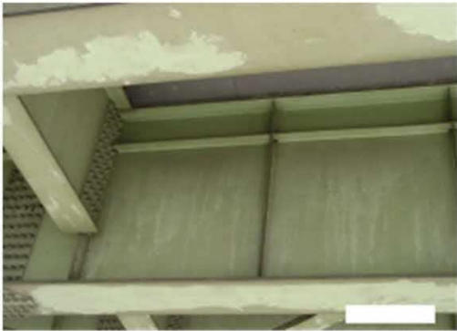
最外層の防食皮膜が変色している。
