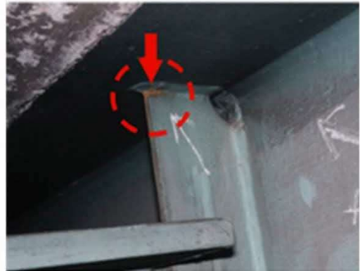
塗膜割れが確認出来る。
