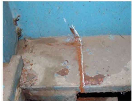
亀裂が生じている。
