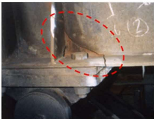
亀裂が生じている。
