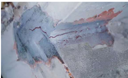
鋼製橋脚隅角部疲労亀裂状況（磁分探傷試験）
