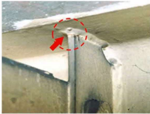
塗膜割れが確認出来る。
