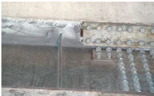
めっき部材の表面に変形が見られる状態
