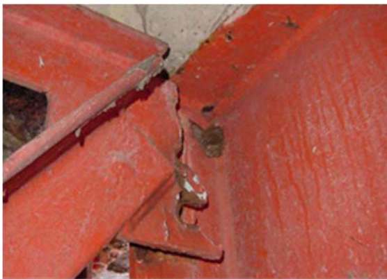
対傾構が破断している。
