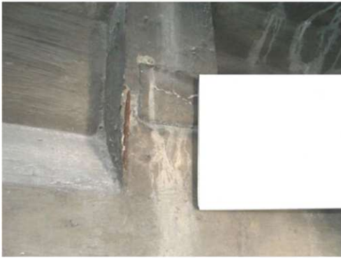
ひびわれからの錆汁を伴う漏水
