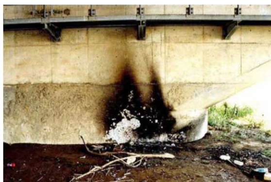
たき火による損傷
