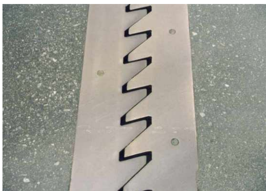
遊間が直角方向にずれている。
