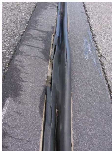
(ゴム) ひびわれが生じている。
