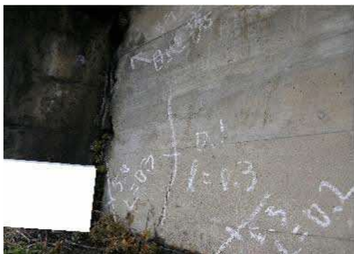
ひびわれ幅(大) : 幅が大きい。 ひびわれ間隔(密) : 間隔が小さい。
