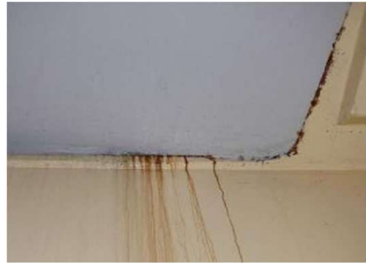
錆汁を伴う漏水が生じている。
