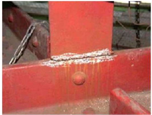
吊り材が破断している。
