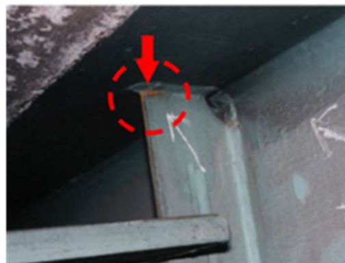
塗膜割れが確認出来る。
