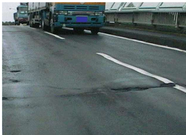
20mm 以上の段差が生じている。
