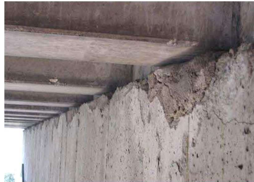
剥離のみ生じている。
