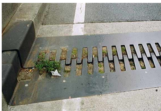
伸縮装置の遊間に土砂詰まりが生じている。
