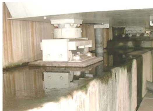
橋座に滞水がある。
