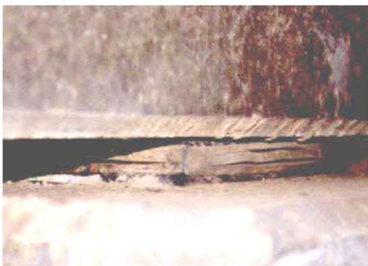
(ゴム) ひびわれが生じている。
