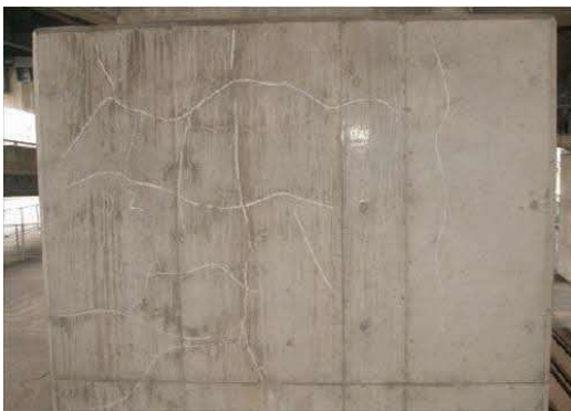
軽微なひびわれが生じている。
