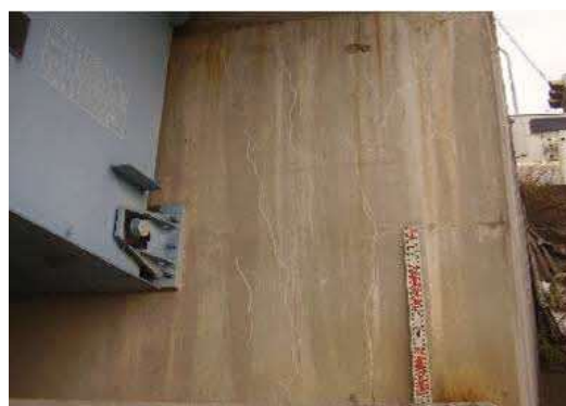
ひびわれ幅(中) : 幅が中位。 ひびわれ間隔(密) : 間隔が小さい。
