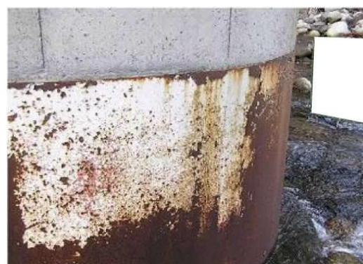
顕著な錆が生じている。
