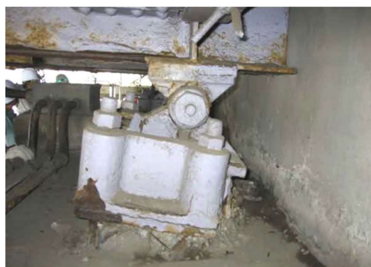
支承が沈下・傾斜している。
