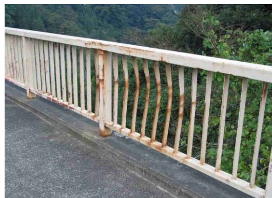
部材が局所的に変形している。
