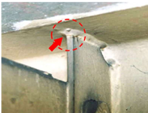
塗膜割れが確認出来る。
