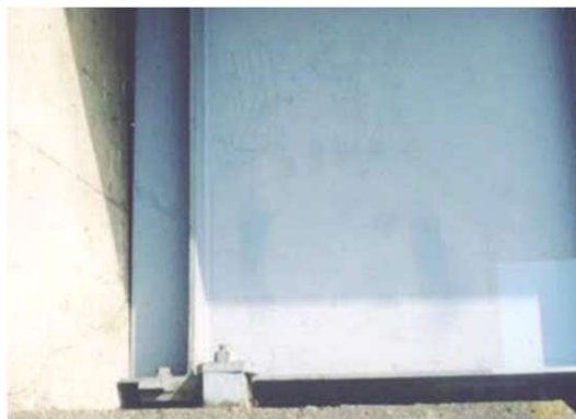
主桁とパラペットが接触している。
