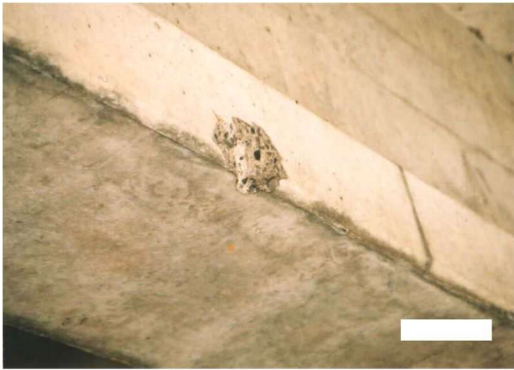
剥離のみ生じている。
