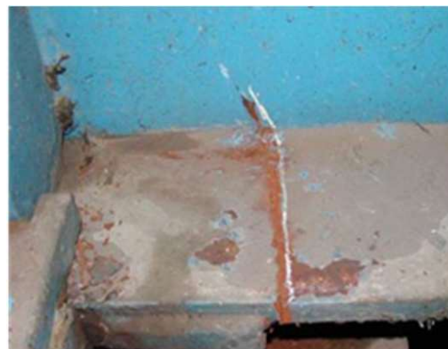
亀裂が生じている。
