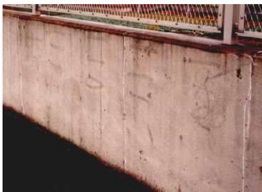
ひびわれ幅(小) : 幅が小さい。 ひびわれ間隔(粗) : 間隔が大きい。
