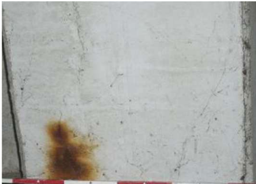
錆汁を伴う漏水が大量に生じている。
