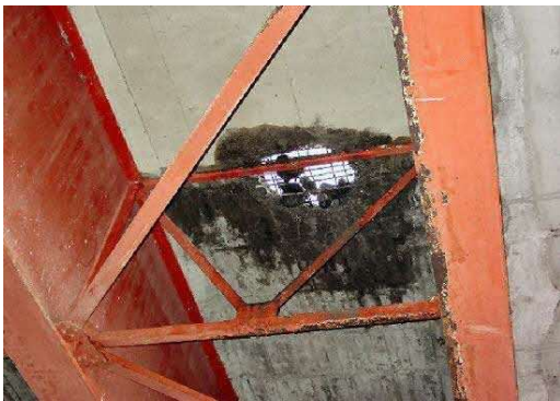
コンクリート塊が抜け落ちている。
