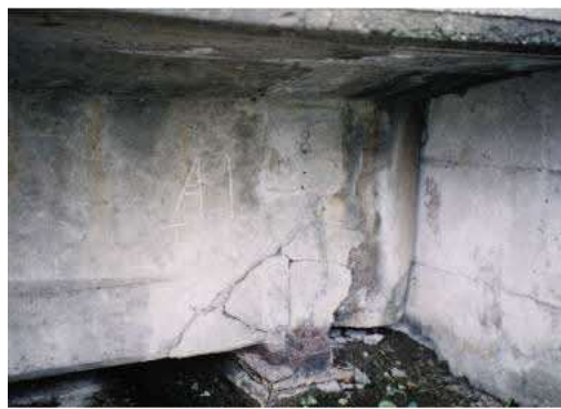
ひびわれ幅(大) : 幅が大きい。 ひびわれ間隔(密) : 間隔が小さい。
