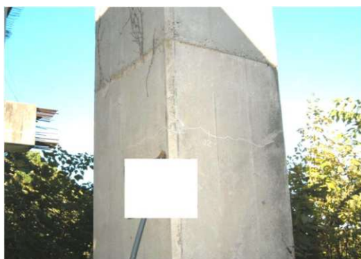
ひびわれ幅(中) : 幅が中位。 ひびわれ間隔(粗) : 間隔が大きい。
