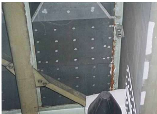
うきは発生していないものの、シール部が一部剥離し、錆及び漏水が見られる
