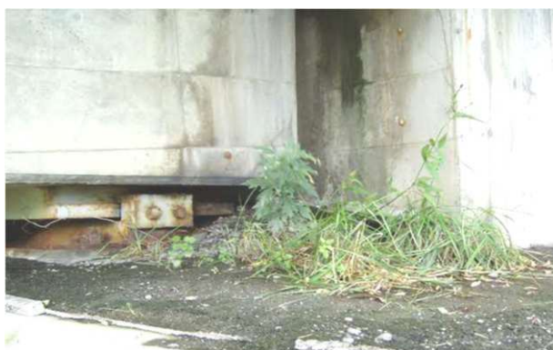
支承周辺に土砂詰まりが生じている。
