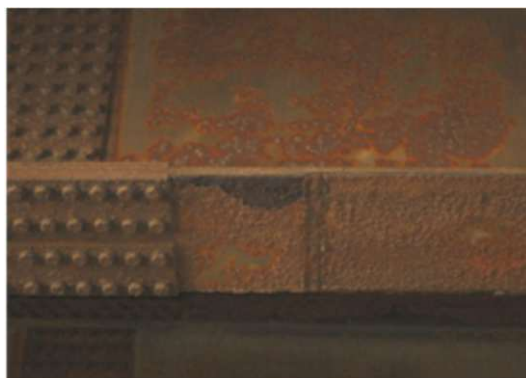
錆は層状の剥離がある。
