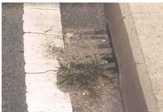
排水桷に土砂詰まりが生じている。
