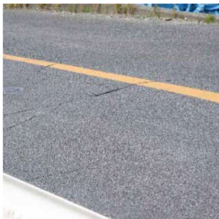
20mm 未満の段差が生じている。
