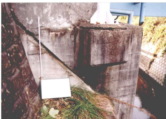
橋台が移動している。
