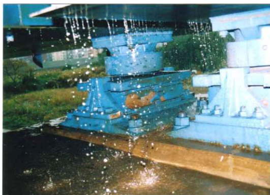
伸縮装置から漏水がある。
