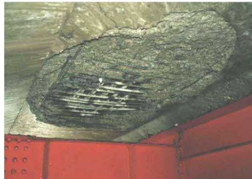
コンクリート塊が抜け落ちている。
