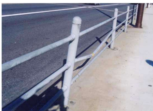
部材が局所的に変形している。
