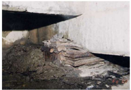
パターン 2 著しい腐食が生じている。
