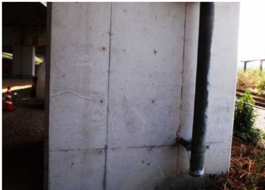
軽微なひびわれが生じている。
