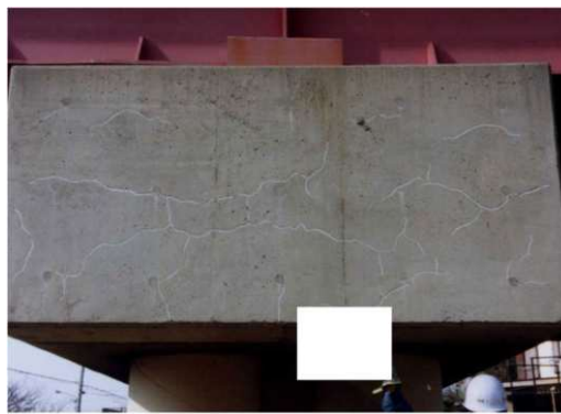
ひびわれ幅(小) : 幅が小さい。 ひびわれ間隔(密) : 間隔が小さい。
