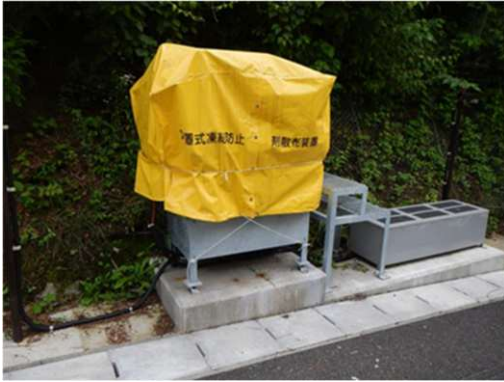
凍結防止剤散布装置
