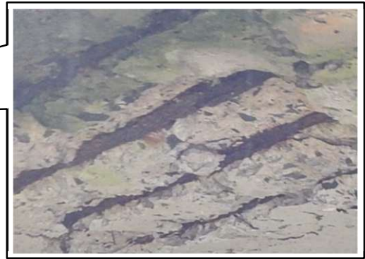
腐食程度：著しい
