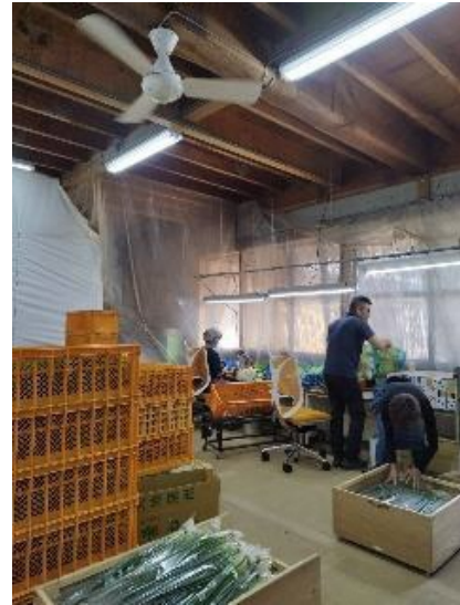
新たに設置した天井扇
