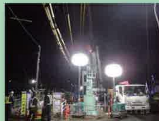
管を削孔する機械を付けて作業中 大型のクレーンを使用しています
