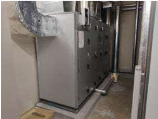
男女共同参画センター系統：AHU-C-1 製造・機種：新晃工業 AJ100-MX 設置箇所：空調機械室 S1-1
