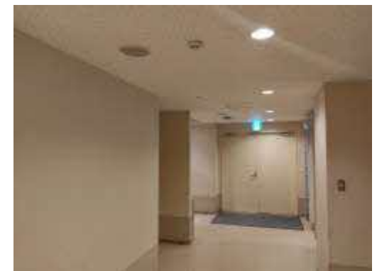
大ホール楽屋廊下系統：AHU-H-7 製造・機種：クボタ空調 KD-08 設置箇所：技術員控室前天井内
