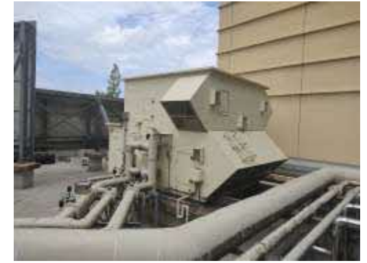
大ホールホワイエ系統：AHU-H-4 製造・機種：クボタ空調 AHR01-31RT
