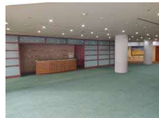
2階ホワイエ系統：AHU-C-3 製造・機種：新晃工業 DC-8 設置箇所：クロック前天井内
