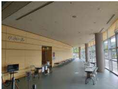
小ホールホワイエ下手系統：AHU-H-6-1 製造・機種：クボタ空調 KD-50 小ホールホワイエ上手系統：AHU-H-6-2 製造・機種：クボタ空調 KD-50 設置箇所：小ホールホワイエ天井内
