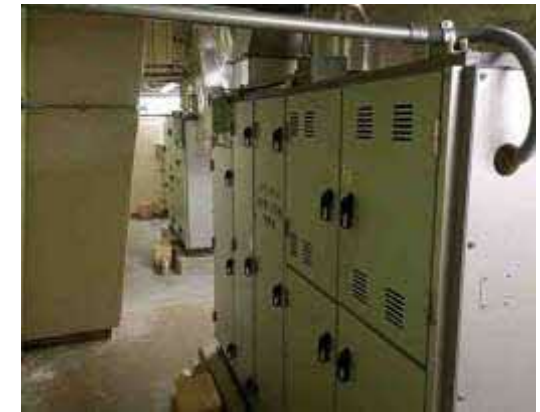
空調機械室(P1-2)内写真。 AHU-M-4 及び AHU-M-5 の2台設置。
