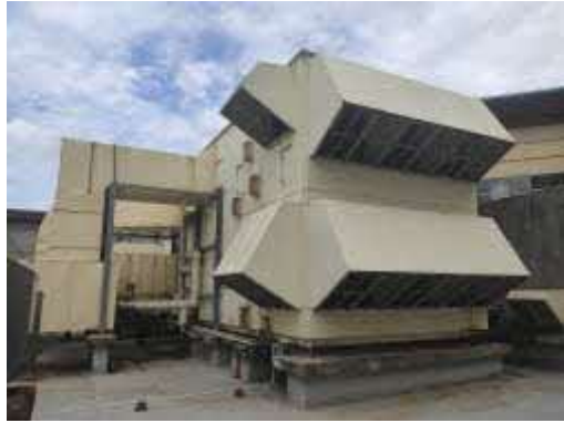
アトリウム系統：AHU-A-1 製造・機種：新晃工業 KV-100
