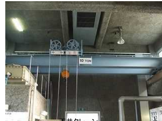
天井クレーン
