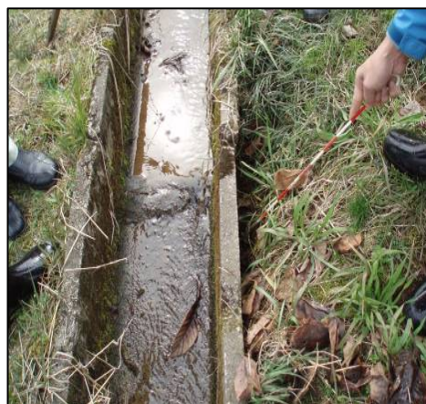
事例2 側壁外側の土が吸出しを受け 流されている
