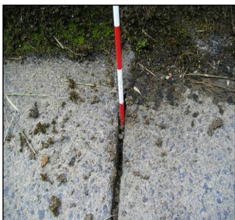
事例1 目地が開いている
