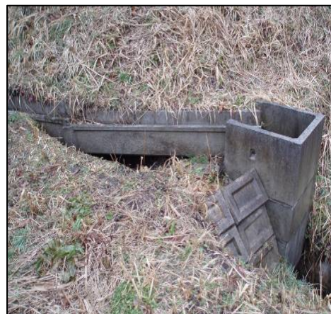
事例4 水路の不同沈下
