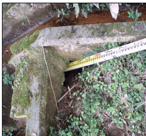
事例3 水路底の空洞化
