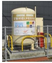
▲災害対応LPガスタンク
