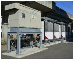
▲非常用ガス発電機、GHP
