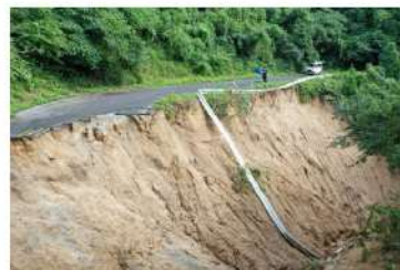
【実光福吉線（三朝町）】 路体崩壊
