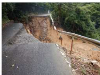
【円谷広瀬2号線（倉吉市）】 路体崩壊
