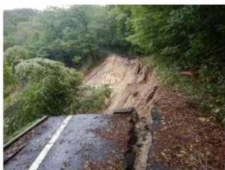
【北栗祖線（三朝町）】 路体崩壊
