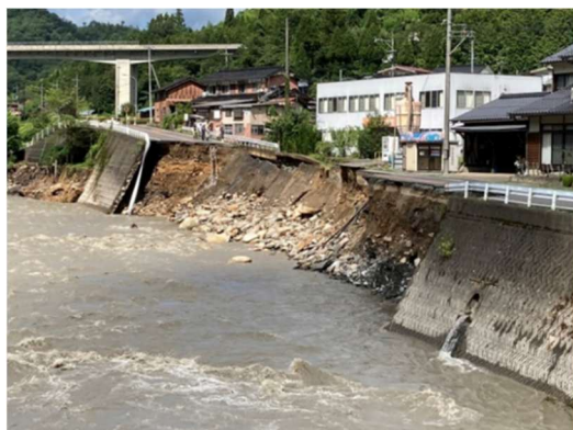
道路兼用護岸の流出崩壊
