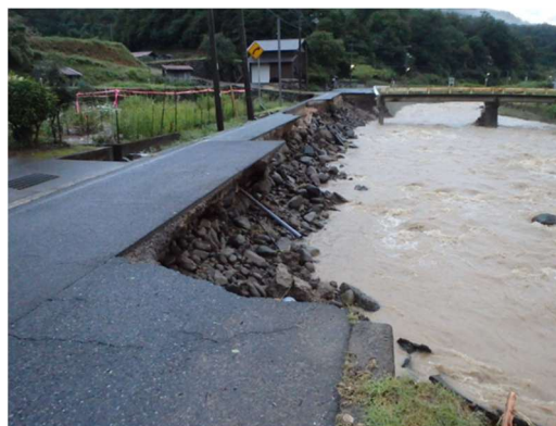
道路兼用護岸の流出崩壊
