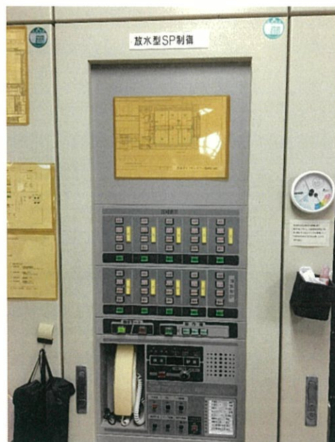
スプリンクラー設備制御盤
