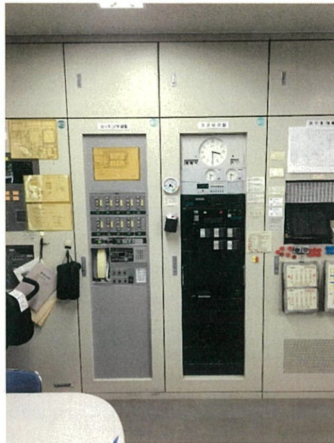
スプリンクラー設備制御盤
