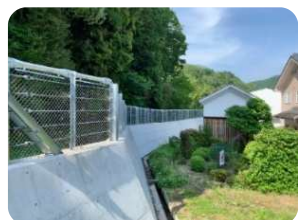
がけ崩れ対策（待受け擁壁）
